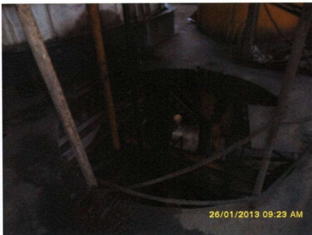
Grande vão aberto em área de circulação. Detalhe de rampa indicando que o local era utilizado para a movimentação de algum tipo de carga, aumentando o risco de quedas.
