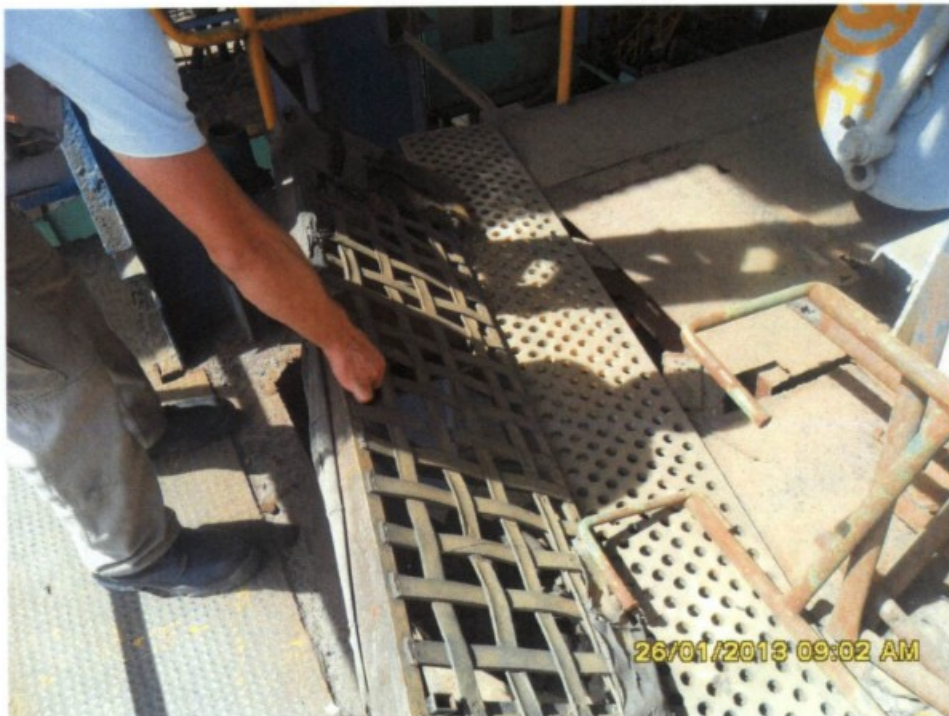
Entulho colocado por sobre buraco no piso em plataforma que fica a mais de 10 metros de altura (acesso às cabines das pontes rolantes). Possibilidade iminente de queda.
