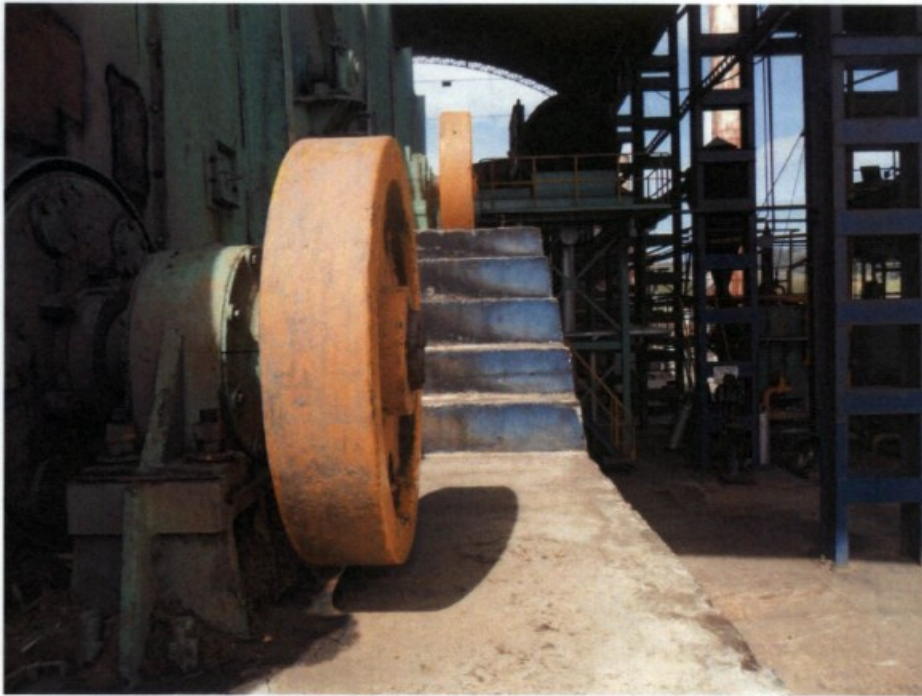
Partes móveis expostas e acessos completamente desprotegidos contra quedas de altura.
