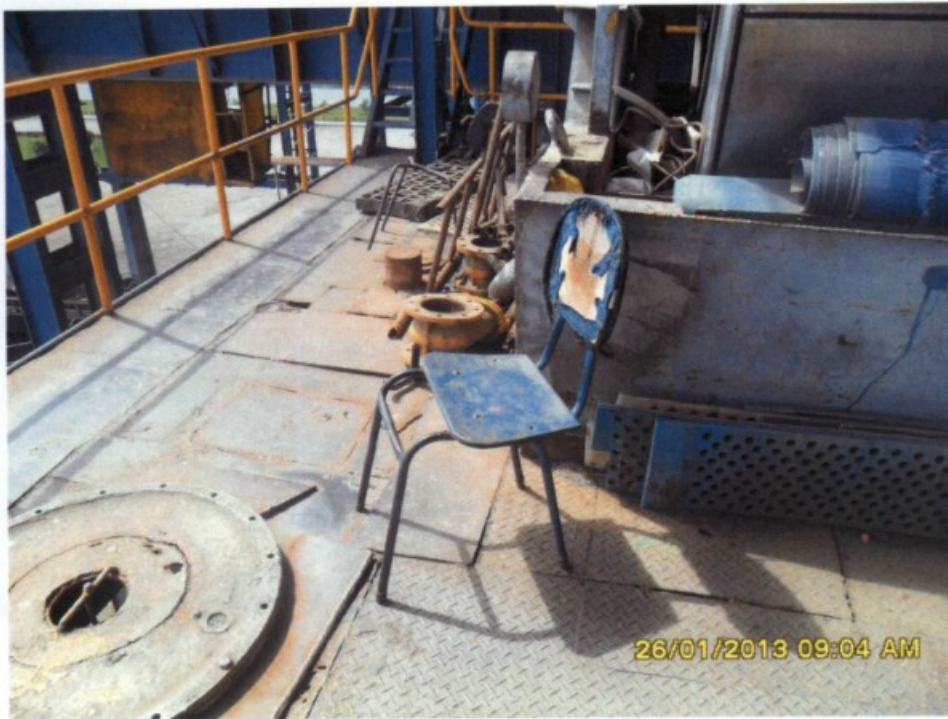
Piso de plataforma de trabalho localizada a mais de 10 metros de altura, com chapas irregulares, soldadas de maneira improvisada, aparentemente, denotando a falta de supervisão técnica adequada e de projeto validando a construção e ampliação das plataformas.
