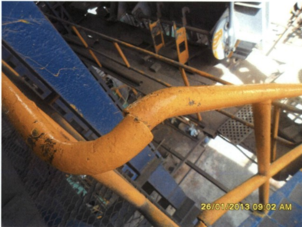
Corrimão desconectado demonstra sinais de desgaste, o que prejudica a garantia de estabilidade e a idoneidade do sistema de proteção coletiva utilizado.
