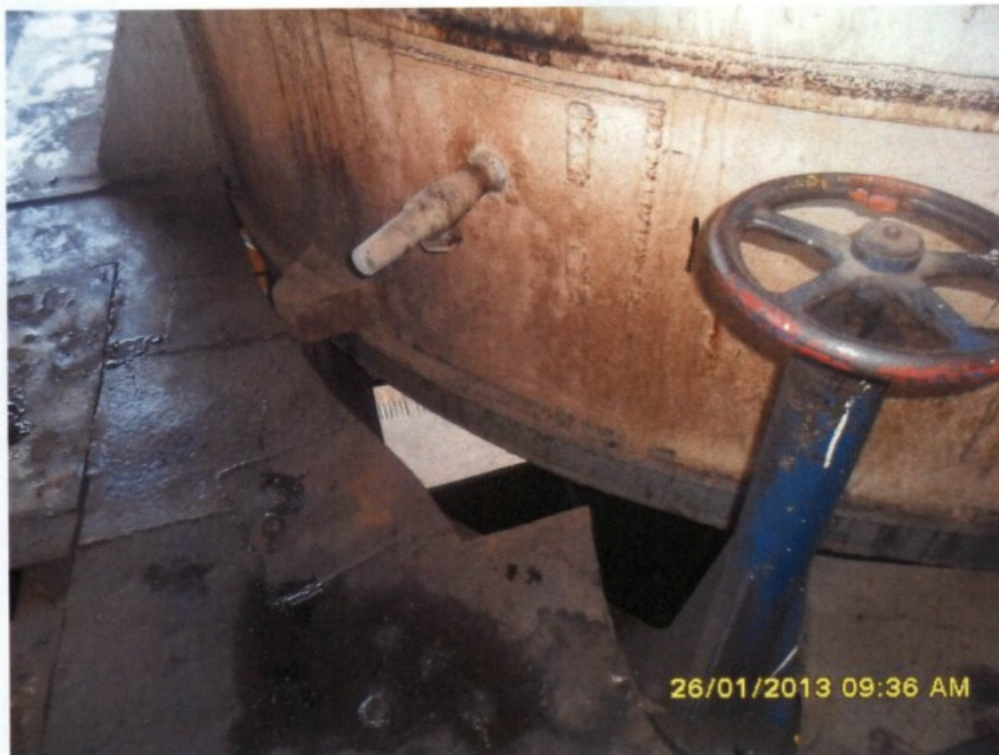
Chapas soldadas de forma irregular, deixando espaços que podem causar acidentes.
