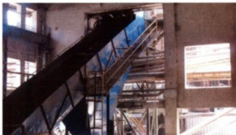
Fotos: 19 e 20: falta de proteção
