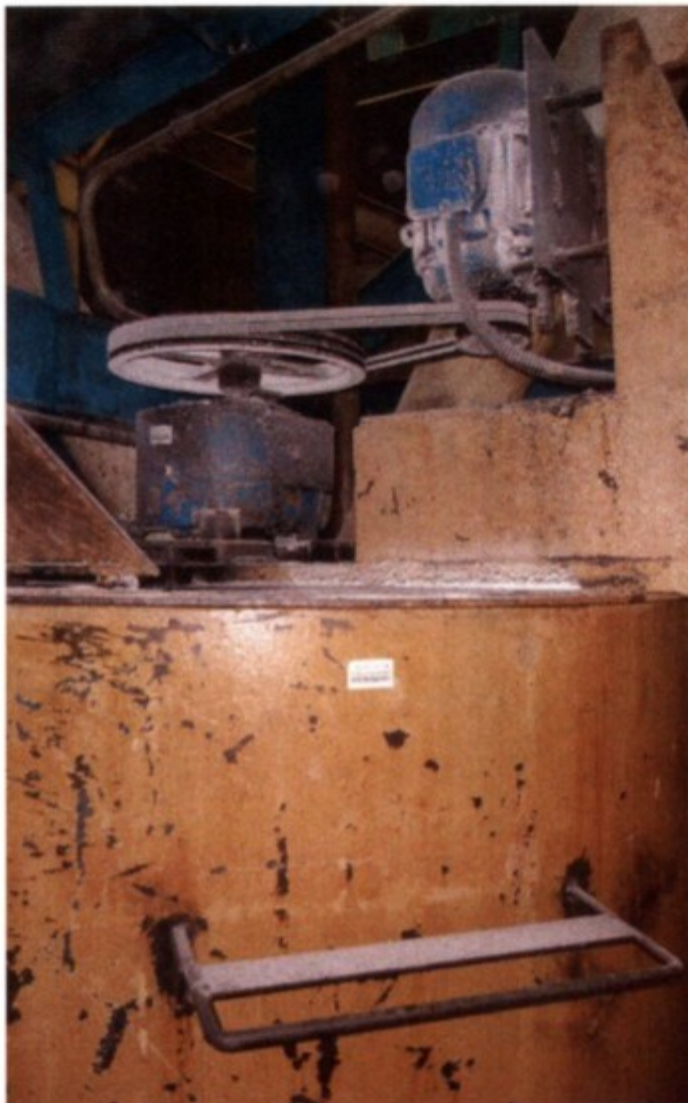
Foto 16: partes móveis sem proteção
