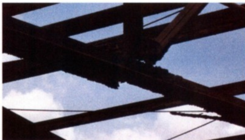
Foto 11: estruturas com corrosão
