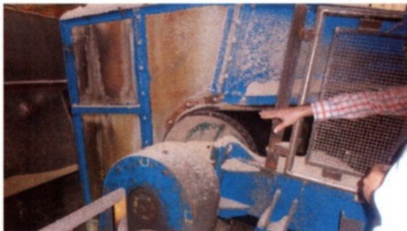
Foto15: falta de proteção das partes móveis
