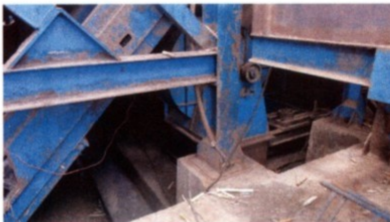
Foto 23: falta de proteção contra quedas
