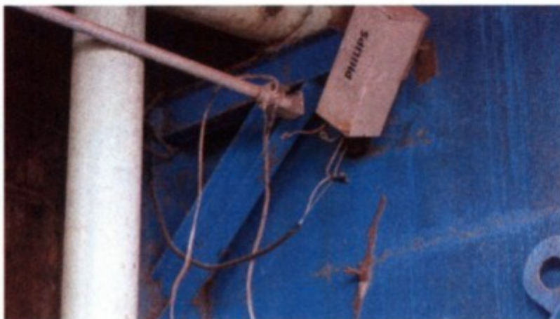
Foto 13; fiação elétrica sem isolamento
