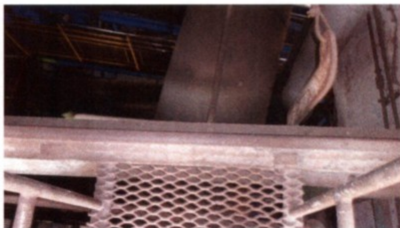
Foto 22: falta de proteção contra quedas
