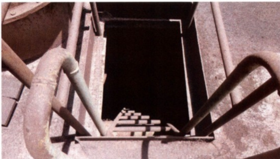
Foto 21: O acesso à tubulação de vapor do acionamento da moenda não apresenta proteção contra queda:
