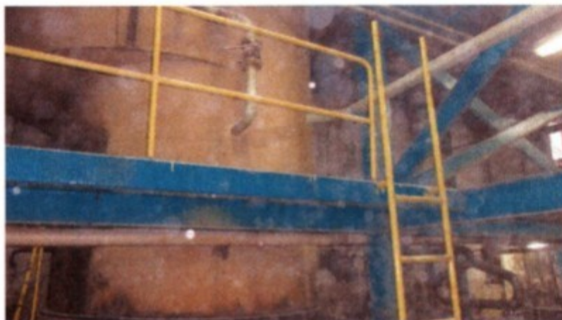
Foto 9: falta de proteção nas escadas
