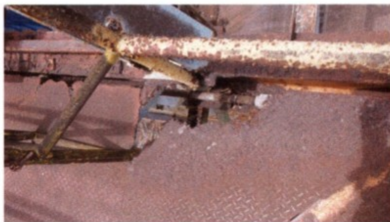
Foto 10: Piso das estruturas corroídas com risco de queda
