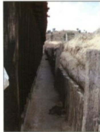
"Corredor" em uma das laterais do "alojamento", usado pelos trabalhadores alojados para ato miccional, especialmente à noite, com odor fétido e manchas ressecadas de urina, à inspeção.
