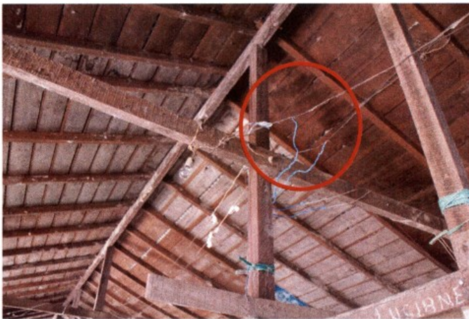
Foto 12: instalações elétricas com risco de choque (gambiarras)
