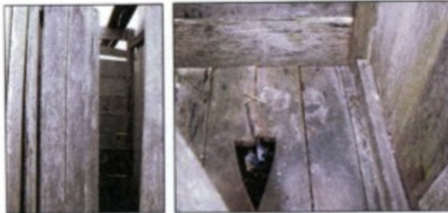
Instalações sanitárias disponibilizadas aos trabalhadores – privada -
