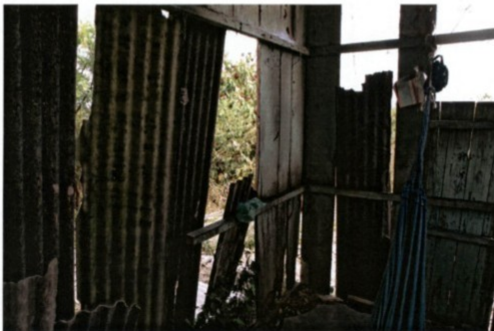
Foto 09: Detalhes dos buracos nas paredes da casa no cômodo o trabalhador dormia.
