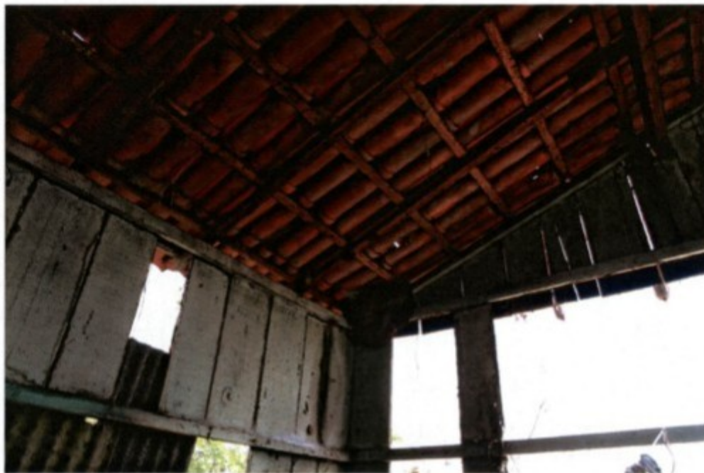
Foto 08: Buracos na parede da casa.
