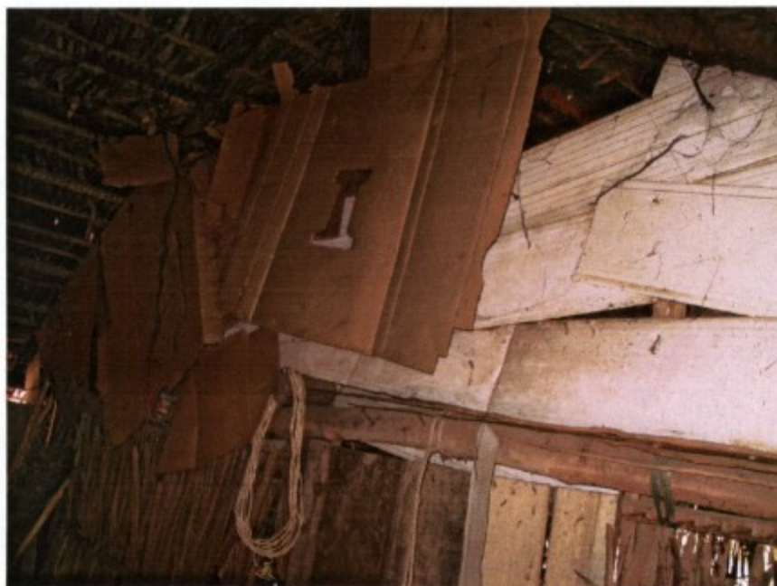
Foto 6: Situação das paredes da casa onde vivia o trabalhador.
