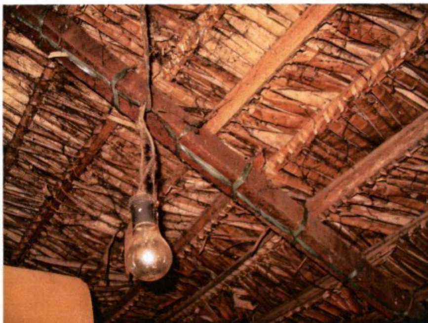
Foto 12: Instalações elétricas no interior do barraco.
