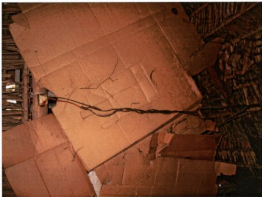
Foto 13: Instalações elétricas, tipo gambiarra, no interior do barraco.
