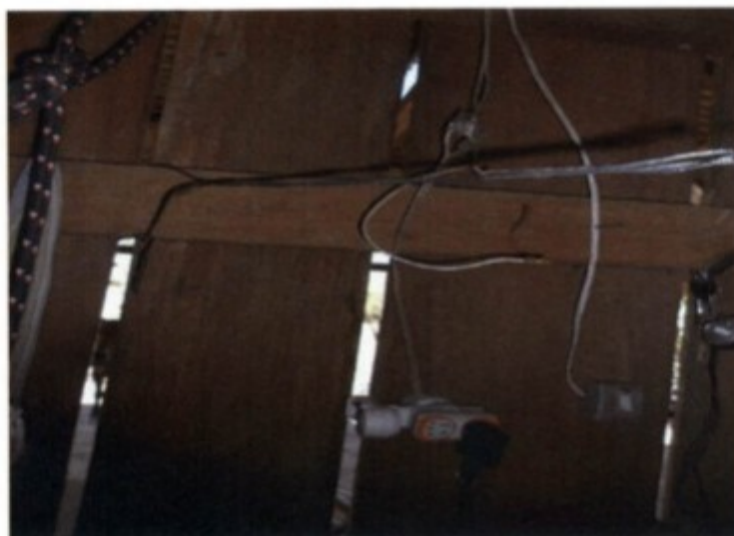
Fig. 9: Instalação elétrica no alojamento dos vaqueiros.
