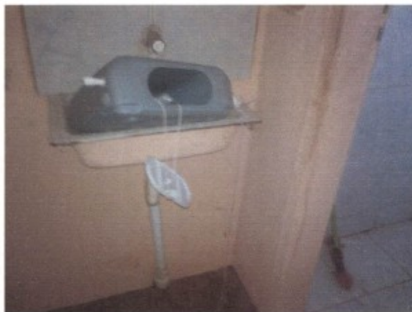
Caixa de descarga quebrada do segundo alojamento
