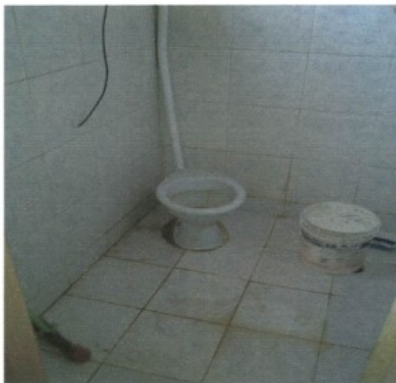
Falta de higienização dos alojamentos – urina espalhada pelo chão do banheiro do segundo alojamento
