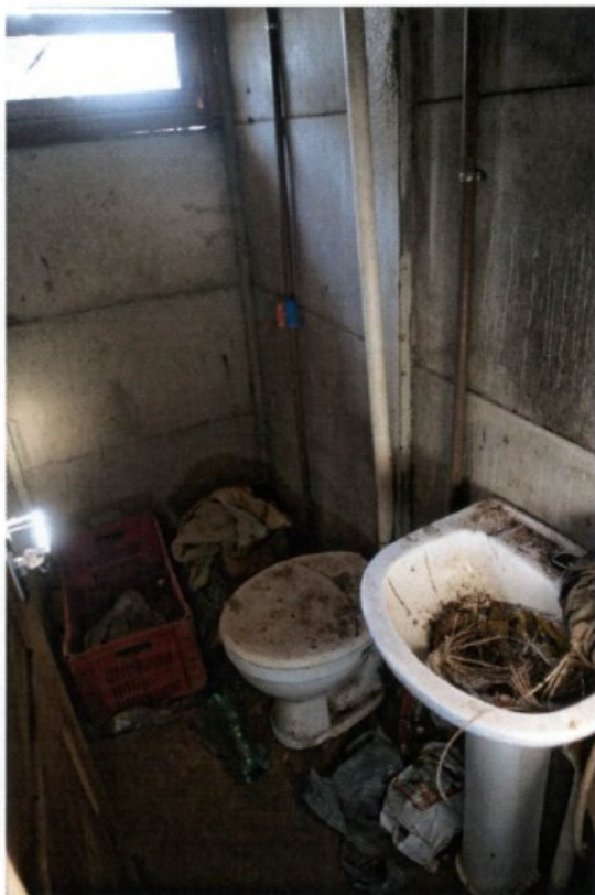
Foto 12: Banheiro sem uso no alojamento.
