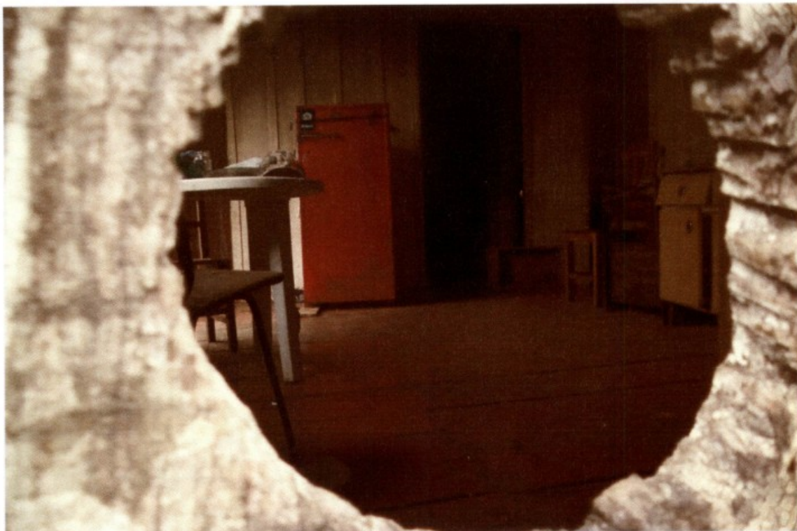
buracos na cozinha favorecendo a entrada de insetos e animais peçonhentos
