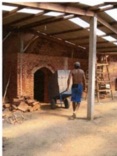
Empregado laborando sem o uso dos EPIs necessários à atividade.
