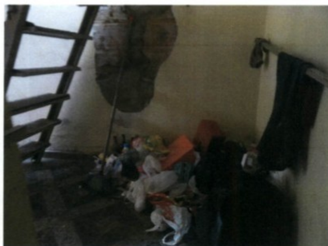
Acúmulo de Lixo.
