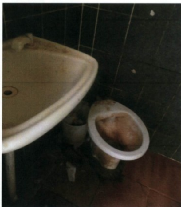
Condições de higiene e conservação dos sanitários.
