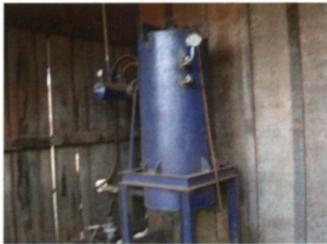
Fotos 27 e 28 – Vasos de pressão sem identificação
