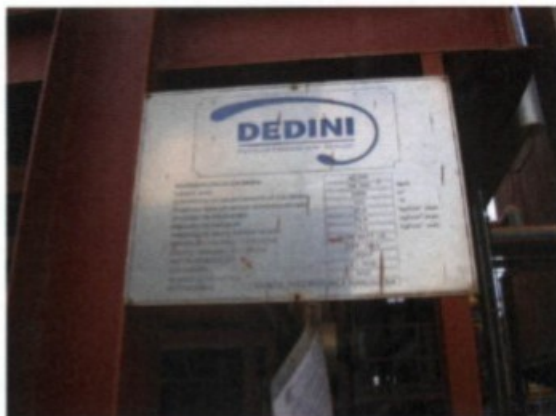
Foto 26 – Placa da caldeira sem a indicação da PMT
