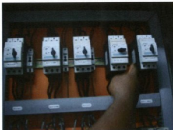
Foto 11 - Painéis elétricos sem identificação
