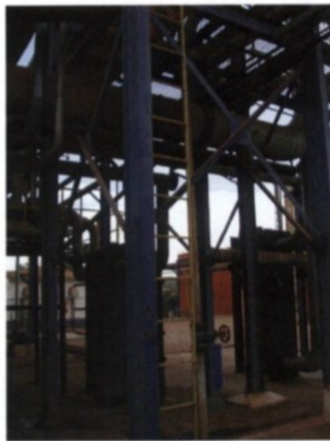
Foto 21 – Escada tipo marinheiro sem gaiola de proteção
