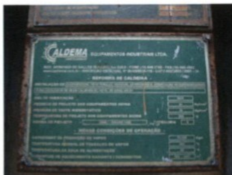
Foto 25 – Placa da caldeira após a reforma sem a indicação do PMTA
