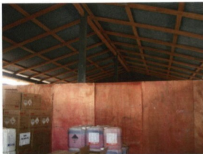
Foto 02 – Parede improvisada de compensado que dividia o local onde estavam armazenados os agrotóxicos e insumos industriais
