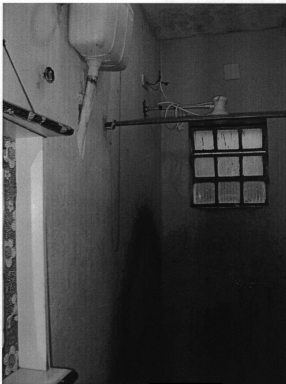
19/01/2012 - alojamento da Rua [REDACTED] embargado pela fiscalização. Único banheiro para onze alojados.
