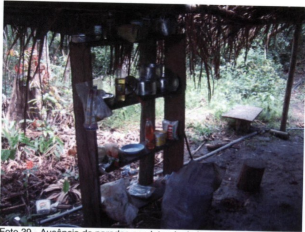
Foto 39 - Ausência de paredes nas laterais do barraco 3.
