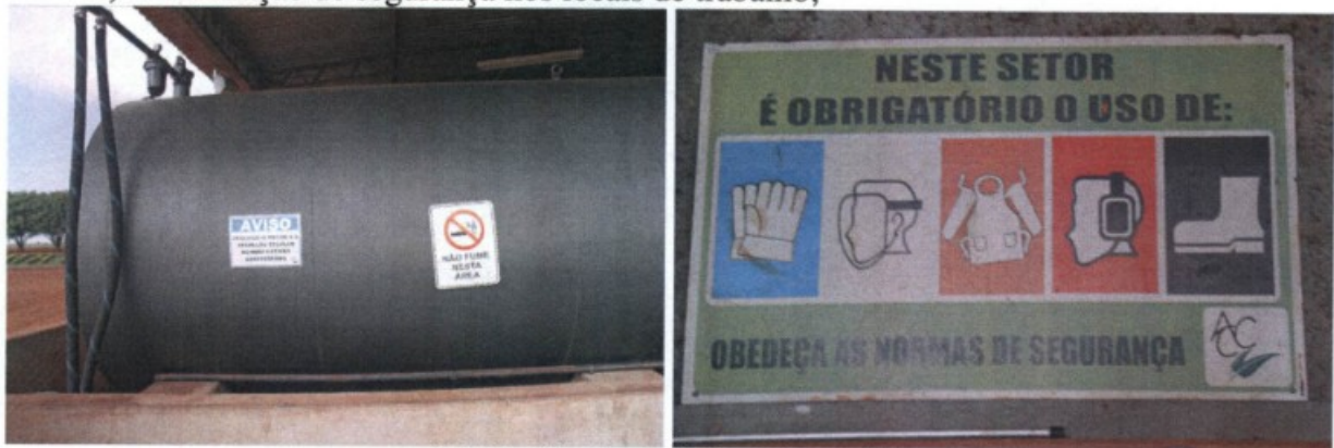
Fotos 29 e 30 – Placa de sinalização de segurança.
