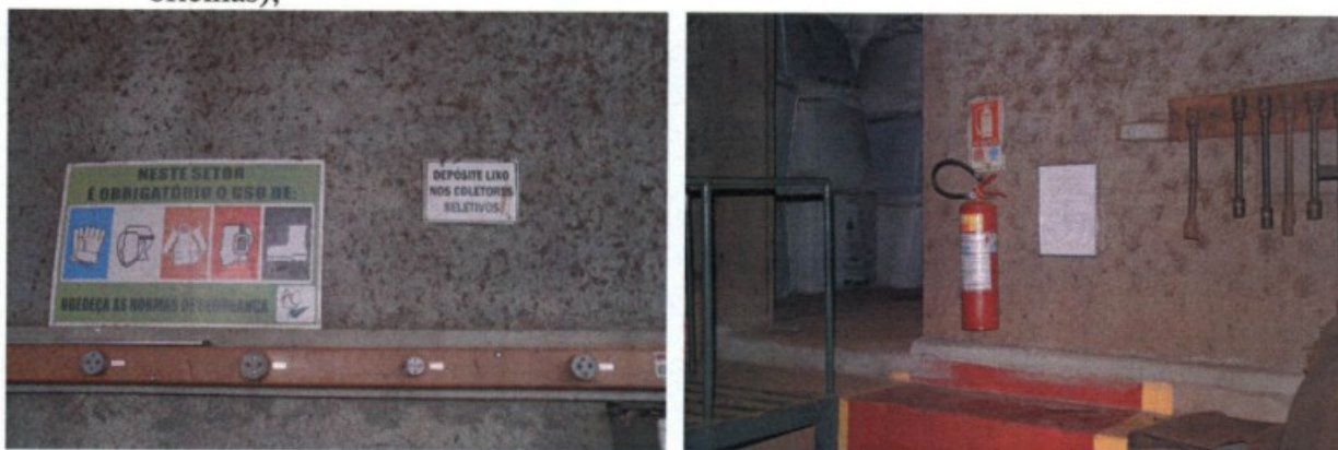
Fotos 25 e 26 – Placa de sinalização de segurança e extintor de incêndio recarregado.
