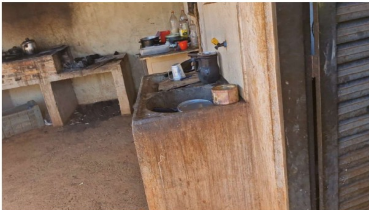
Figura 5 cozinha com duas frentes destituída de paredes, sem local adequado para preparo e tomada de alimentos
