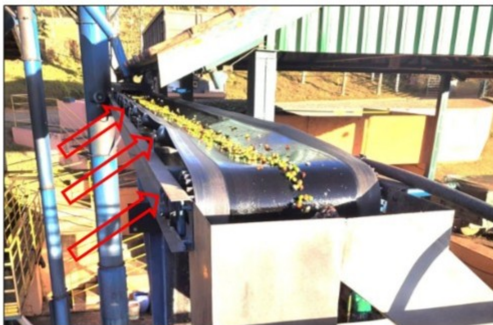
Imagem acima: Esteira transportadora de café sem proteção dos movimentos perigosos (setas indicativas).
