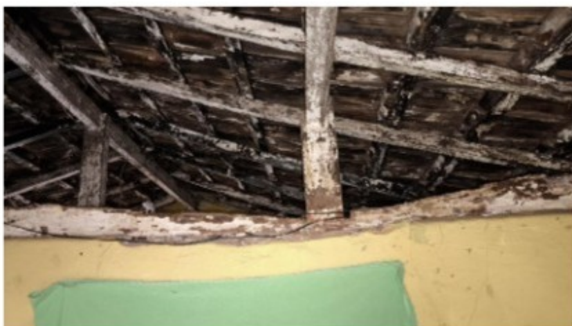
Figura 24 – Detalhe do madeiramento do telhado, deteriorado e empenado.
