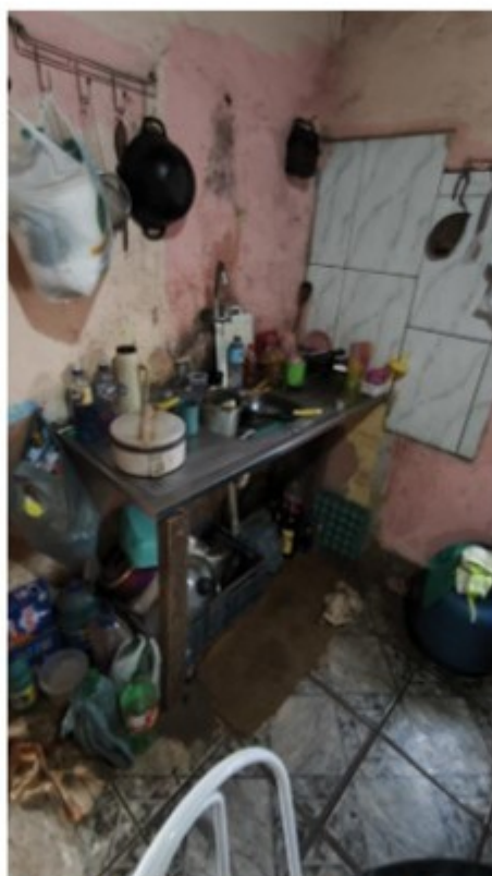
Figura 26 – Cozinha da Casa 6, com acúmulo de utensílios e paredes sujas.
