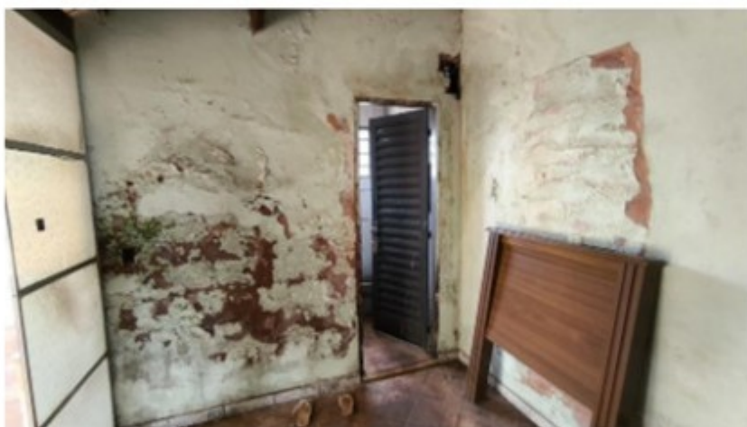
Figura 20 – Parede do interior da edificação, com reboco soltando, impossibilitando a limpeza.
