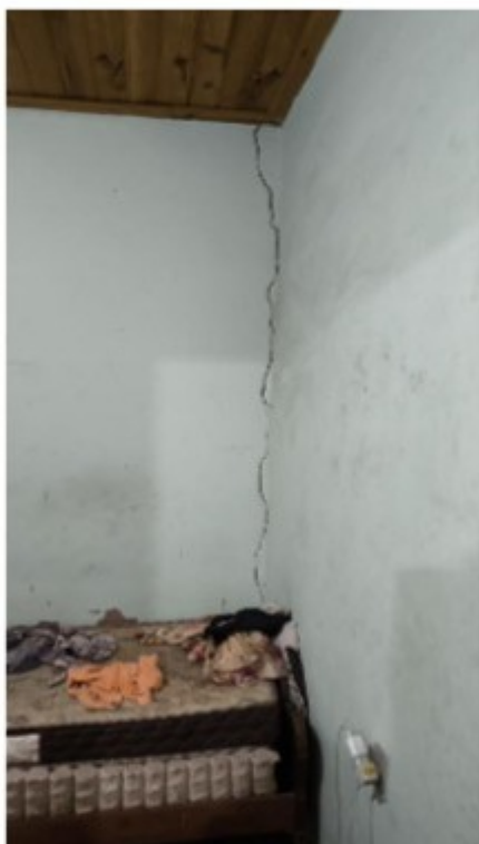
Figura 21 – Rachadura em uma das paredes de dormitório.
