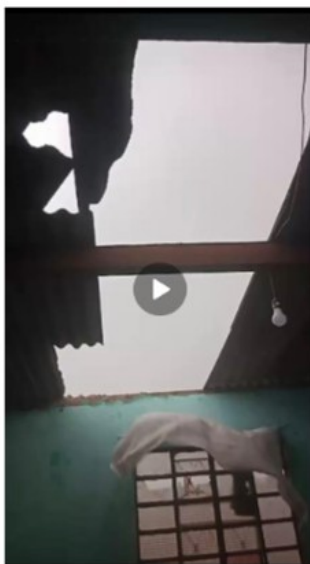
Figura 25 – Frame de vídeo enviado à fiscalização, mostrando o telhado da mesma casa logo após o destelhamento.
