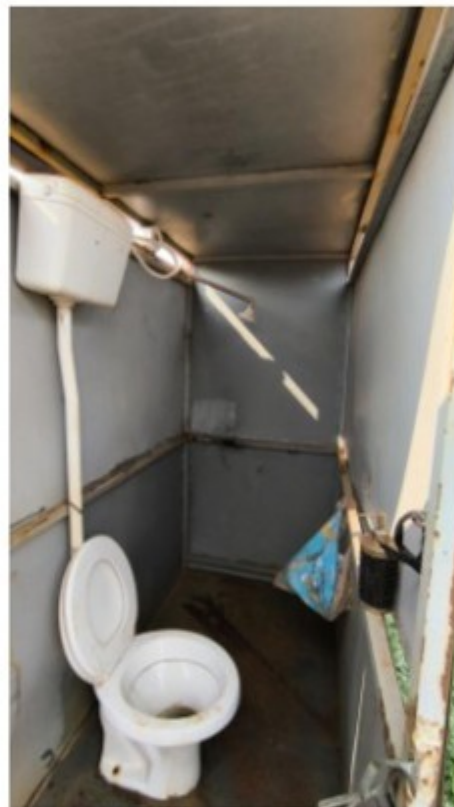
Figura 9 – Instalação sanitária da frente de trabalho inspecionada. Observa-se vaso sanitário e, ao fundo e acima, pequeno chuveiro. Não havia água nem para banho, nem para descarga.
