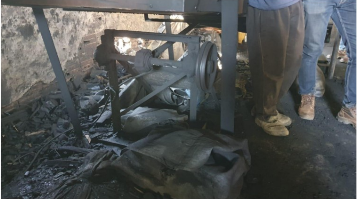
Foto 11: Maquinário com as transmissões de força expostas.
