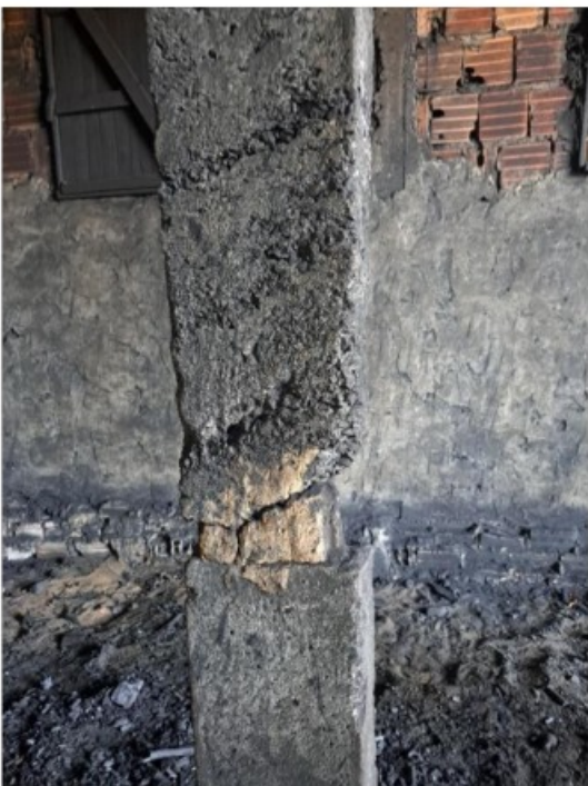
Foto 05: Vista aproximada de outro pilar, com degradação aparente.
