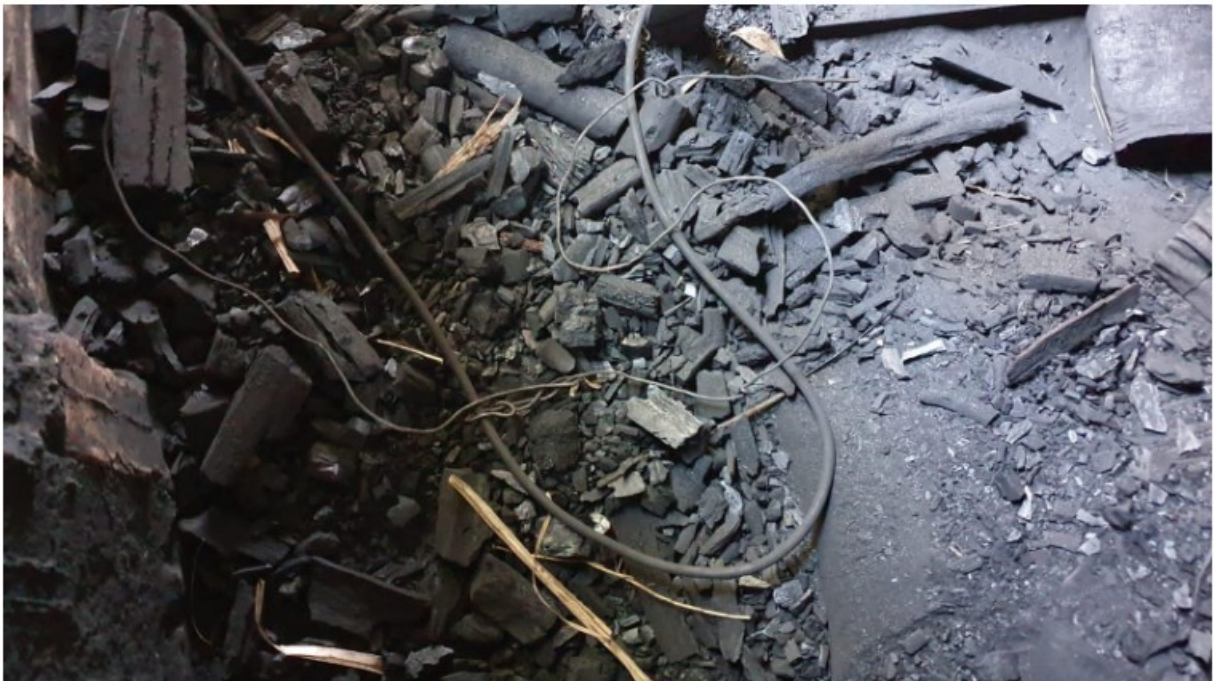
Foto 12: Destaque no piso do galpão. Material acumulado. Sujidade. Fiação em condições precárias.
