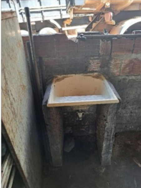
FOTO 18: Uma segunda pia instalada na varanda do alojamento.
