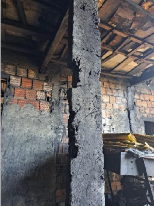
Foto 04: Vista aproximada de um dos pilares do depósito, com ferragem aparente.
