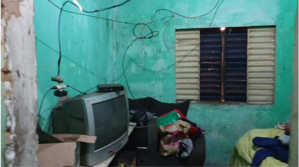
FOTO 26: Interior do alojamento. Destaque: condições das instalações elétricas.
