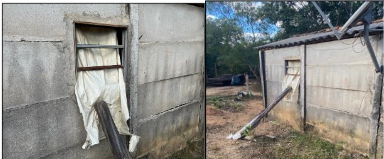
Fotos 27 e 28 - Na imagem verifica-se ausência de vedação na janela do quarto de [REDACTED]. O trabalhador colocou uma lona para tapar a abertura da janela e uma tora de madeira no lado externo para segurar esta lona.
