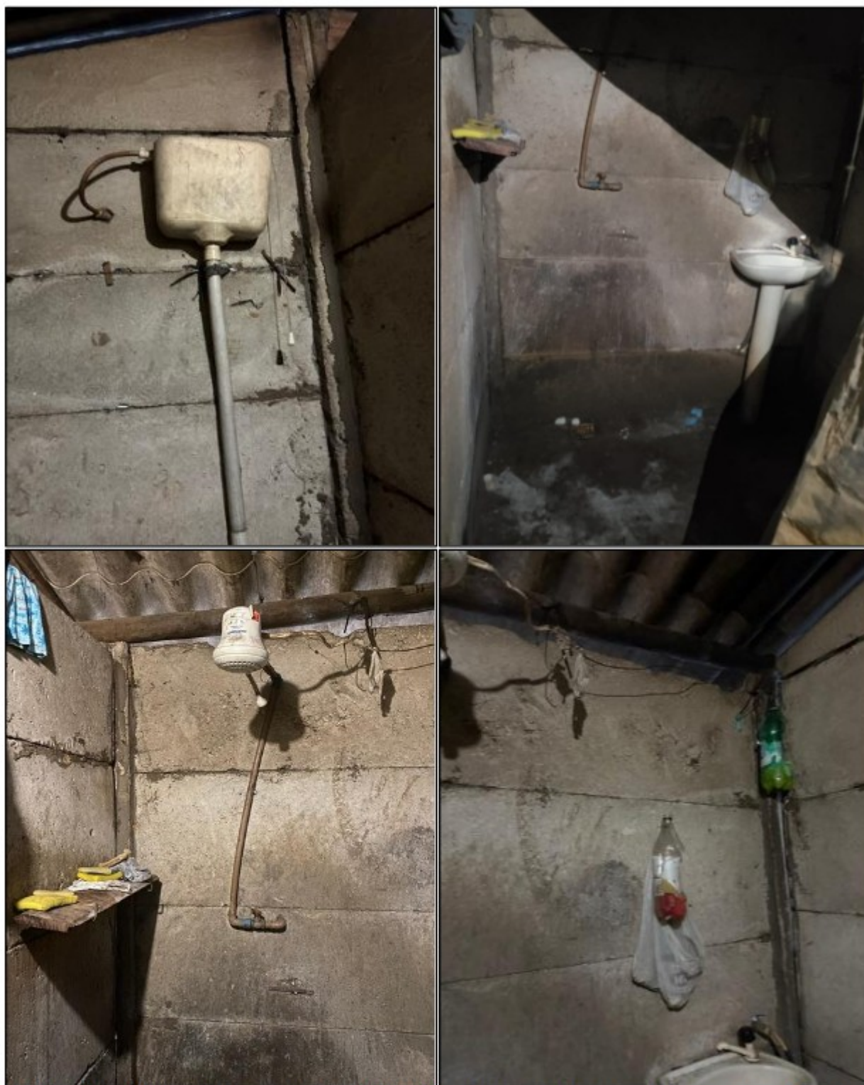
Fotos 31 a 34 - Outras imagens do banheiro. O banheiro não tinha portas nem janelas. Na imagem verifica-se que o chuveiro possuía instalação elétrica extremamente precária, com partes vivas expostas e emendas feitas com pedaços de sacolas plásticas. O chuveiro só esquentava quando luzes e outros equipamentos, a exemplo de ventilador, não estivessem em funcionamento, em razão da sobrecarga que a ligação concomitante provocava na precária e subdimensionada instalação elétrica.
