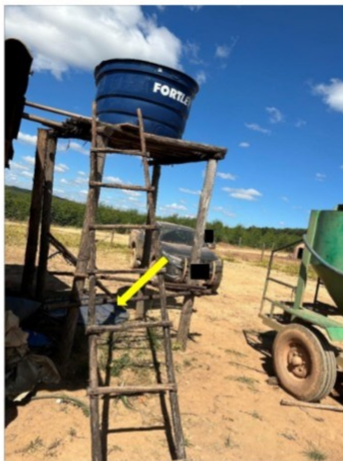
Foto 18: Registro fotográfico mostra caixa d'água suspensa do alojamento de coordenadas S 19°6'2" W 45°12'10", que era mantida aberta – note-se a tampa em solo. A água armazenada, consumida pelos trabalhadores para reposição hídrica, para preparo de alimentos, lavagem de utensílios e banho estava contaminada por material particulado, insetos mortos e até por um sapo.
