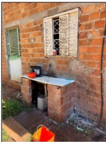
Pia instalada na lateral da casa.
