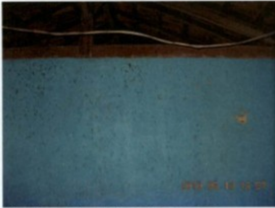
Paredes repletas de fezes de morcegos.
