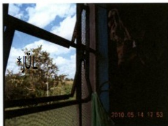
Janelas sem vidros.
