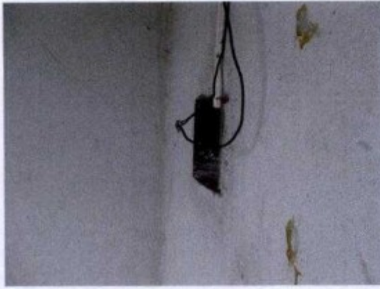
Fotos: instalações elétricas inadequadas
