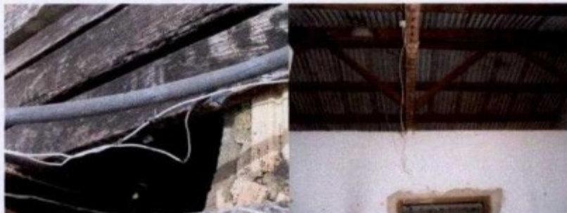
Fotos: fiação exposta Risco de incêndio
