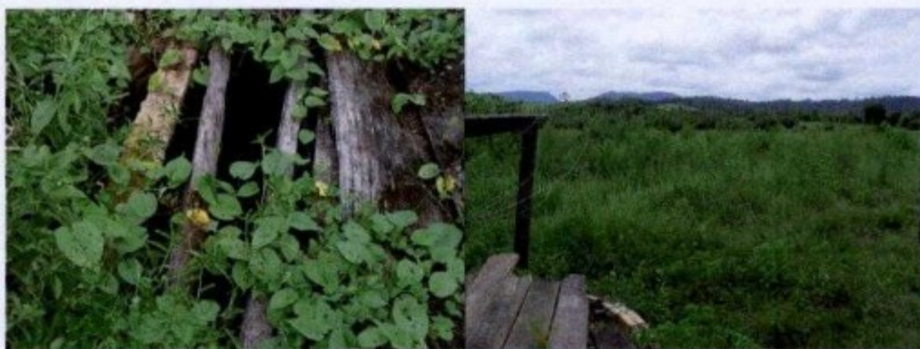
Foto: fossa e poço Risco de contaminação da água
