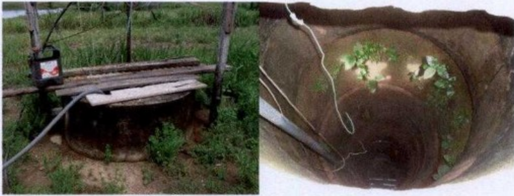
Foto: poços abertos Risco de contaminação da água
