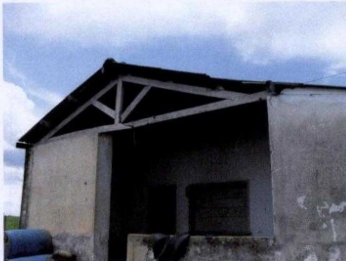
Foto: peças de madeira apodrecidas Risco de desabamento
