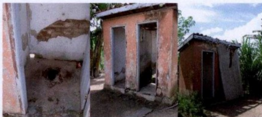
Foto: instalações sanitárias e chuveiro
