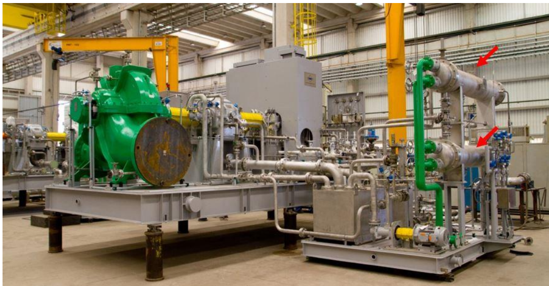
Figura 6 - Exemplos de recipientes sob pressão integrantes de pacote de máquinas – skid conjugado
