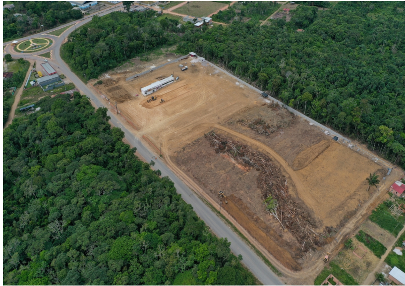
Visão geral SE Itapiranga 138/13,8 kV
