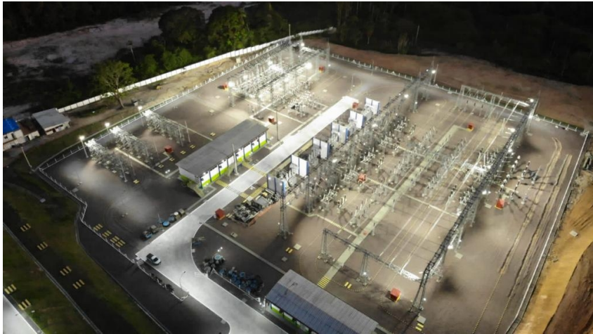
Subestação JOÃO PAULO 138/69/13,8 kV
