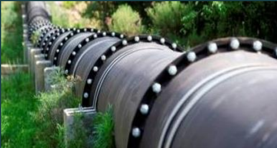
Estruturas de captação e tratamento de água
