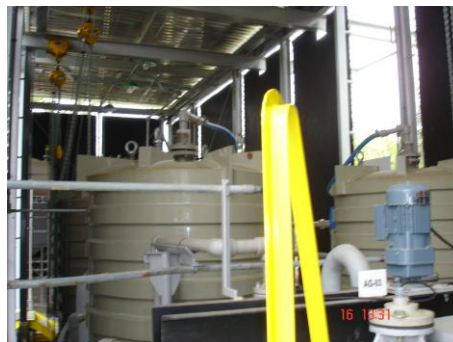
Foto 2: Instalações da ETAS
