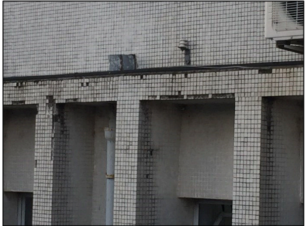
Figura 23 – Fachada anterior da delegacia. Note-se o estado do revestimento em pastilha.
