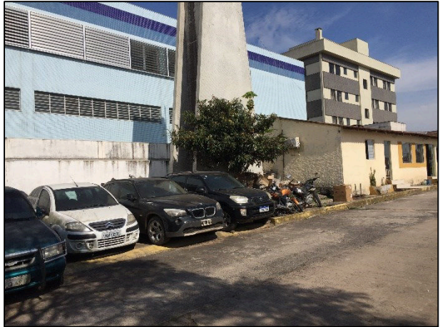
Figura 39 – Outra vista do mesmo depósito. O local necessita de uma cobertura.
