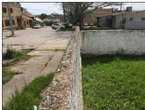
Figura 11 – Outra vista do mesmo muro, esquina das ruas Marechal Floriano e Júlio de Castilhos.
