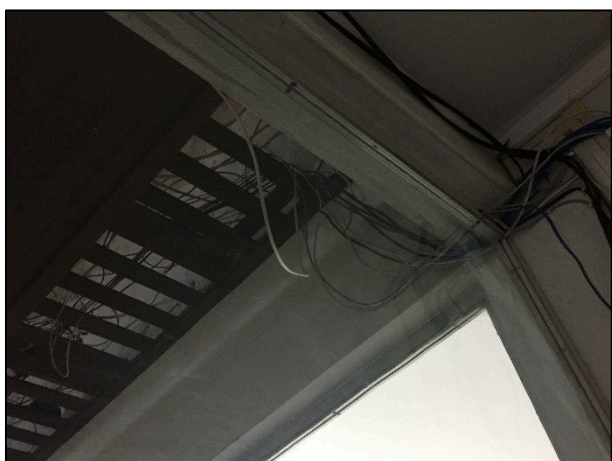
Figura 28 – Detalhe da fiação que corre por cima do forro de madeira.
