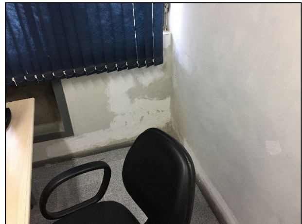
Figura 21 – Note-se o estado de algumas paredes.
