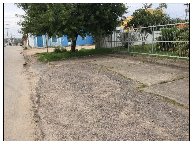
Figura 7 – Mesma calçada. Note-se o mau estado da pavimentação.
