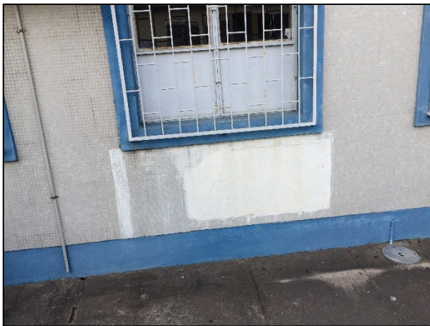
Figura 24 – Fechamento de vão de ar condicionado sem recomposição das pastilhas.
