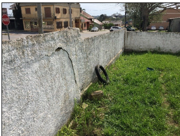
Figura 10 – Vista do muro com rachaduras.
