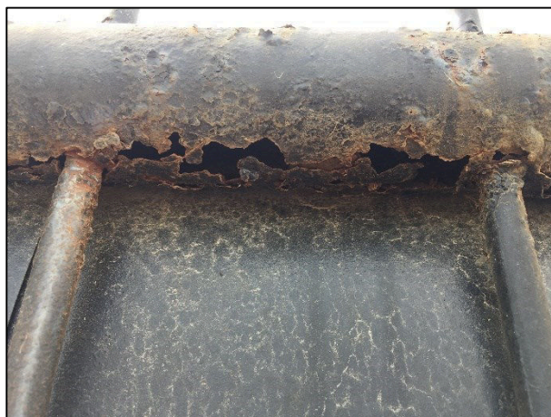
Figura 42 – Outra vista do mesmo portão. Note-se o estado avançado da ferrugem.
