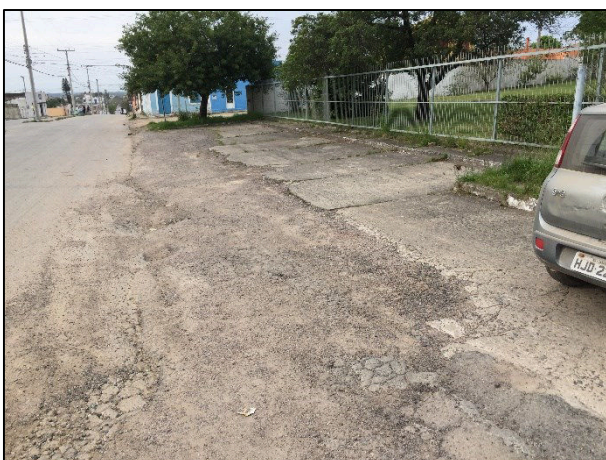
Figura 6 – Outra vista da mesma calçada. Note-se a ausência de um passeio.
