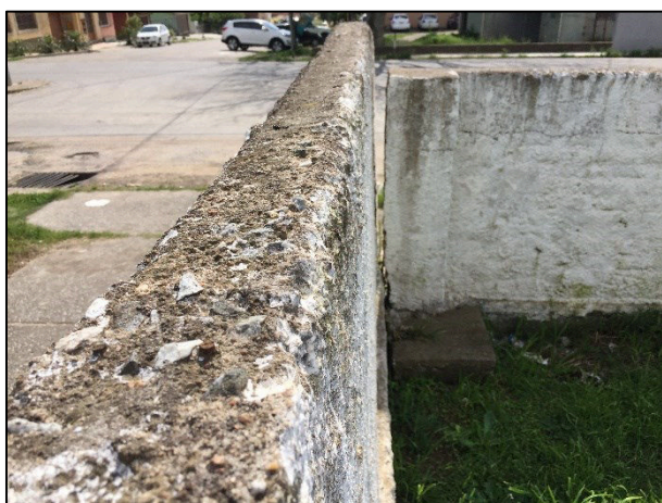
Figura 12 – Mesmo muro. Note-se a fresta existente entre as alvenarias.
