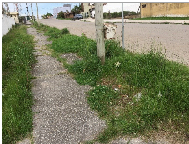
Figura 9 – Note-se o mau estado da calçada.
