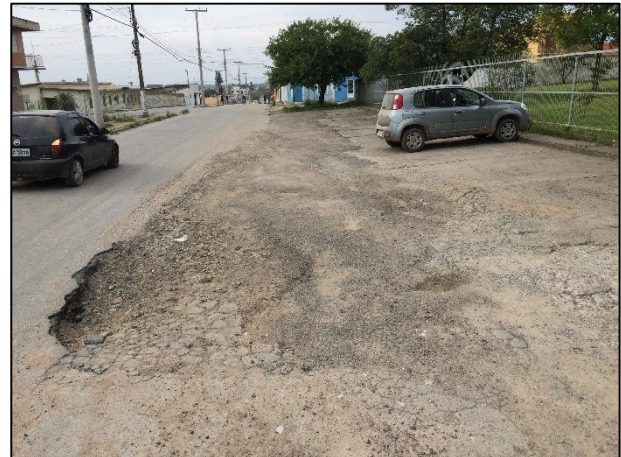
Figura 5 – Mesma calçada. Note-se os desníveis e buracos.
