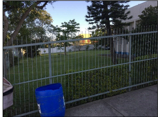
Figura 15 – Gradil a ser reformado, de forma a permitir o acesso ao módulo de banheiros.
