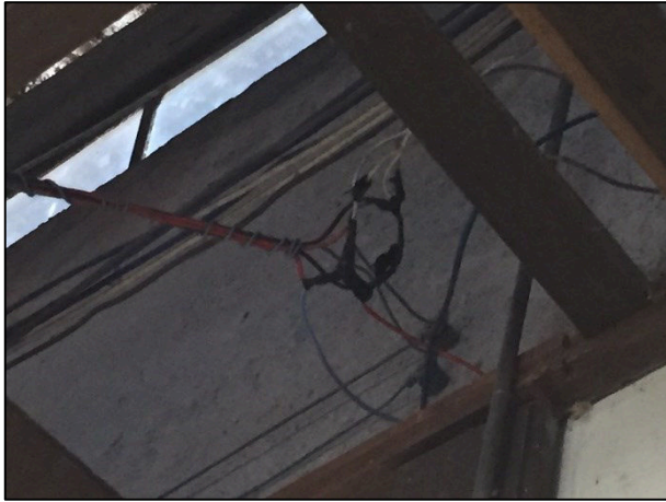
Figura 30 – Detalhe de uma ligação elétrica por cima do forro de madeira.
