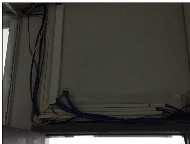
Figura 27 – Passagens de cabos UTP após sucessivos acréscimos na rede.
