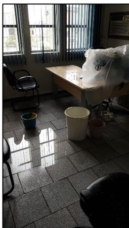
Figura 32 – Infiltração de água de chuva ocorrida no dia 13/10/19.
