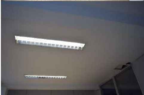
Iluminação fluorescente. Teto com forro, rebaixado.
