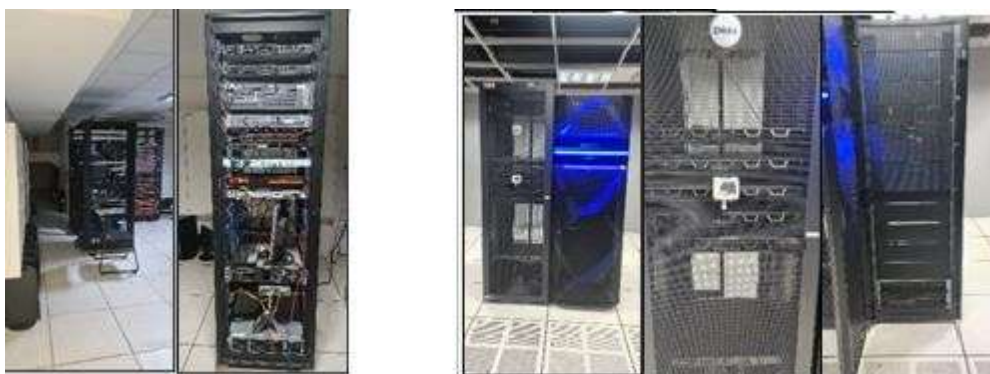
Figura 6 - Infraestrutura de TIC (sede) e colocation no Serpro
