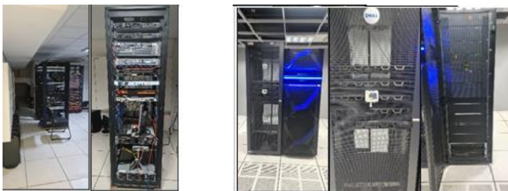
Figura 6 - Infraestrutura de TIC (sede) e colocation no Serpro
