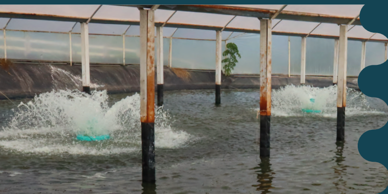
Aeradores e motobombas
