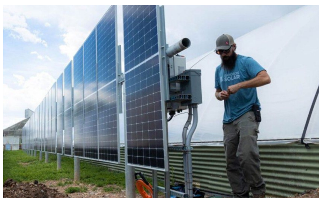
Figura 8 - Sistema fotovoltaico vertical associado a estufas
