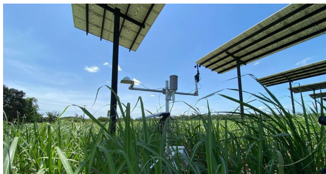
Figura 37 - Sistema agrivoltaico com sete estruturas de módulos FV
