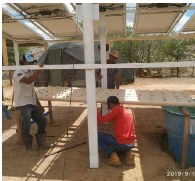
Figura 33 - Sistema agrivoltaico e montagem do sistema aquapônico abaixo dos módulos
