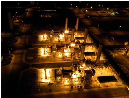
Vista noturna dos turbogeradores da UTGCA
