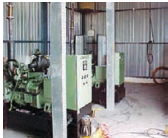
Grupos geradores a diesel
