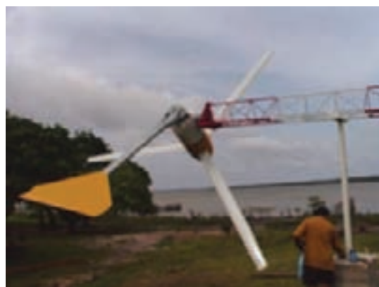
(d) Aerogerador acoplado ao topo da torre
