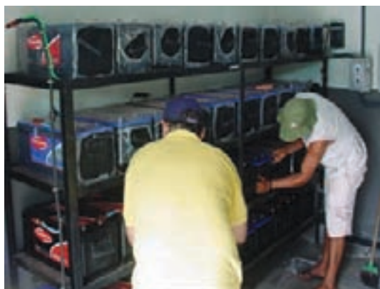
Banco de baterias novo (instalação)
