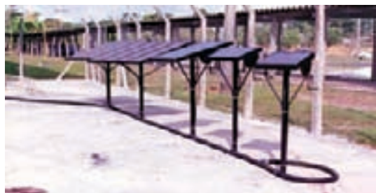
(a) Módulos fotovoltaicos instalados em pequenos postes
