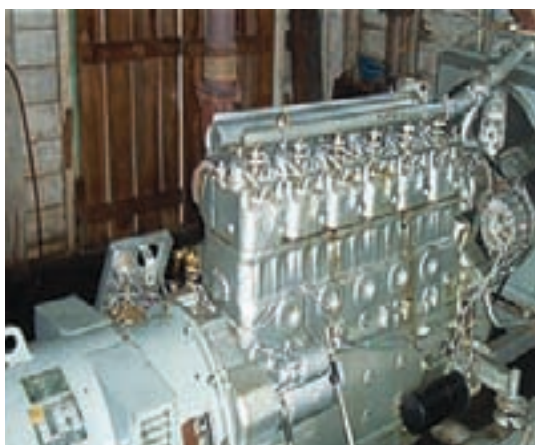
Grupo gerador a diesel existente
