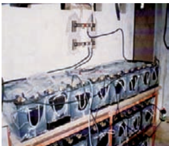
Banco de baterias
