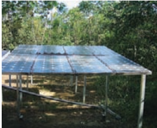
Figura 10.3 – Módulos instalados em região de sombreamento
