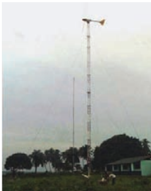
(a) Torre treliçada estaiada/aerogerador de pequeno porte
