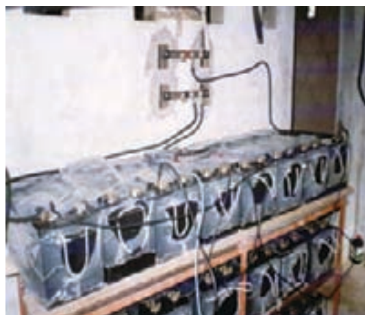
(b) Banco de baterias
