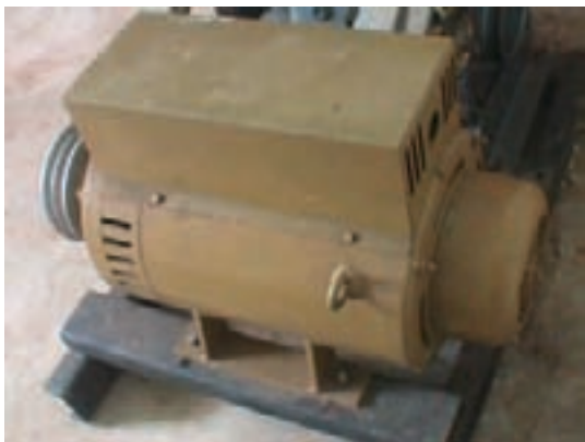
Gerador elétrico trifásico
