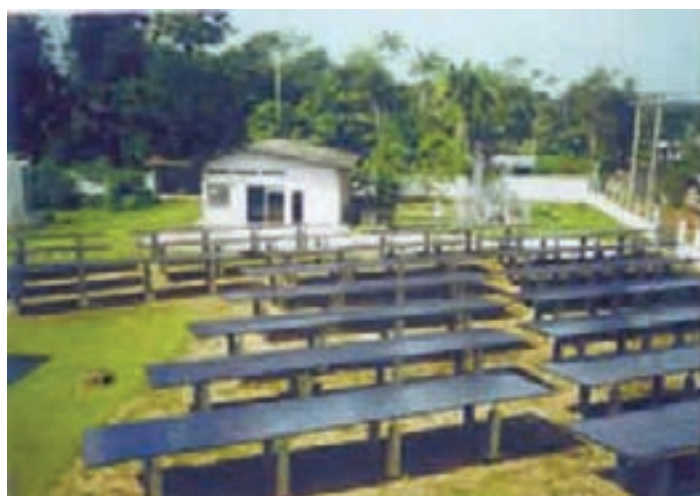
Figura 13.2 – Vista do arranjo fotovoltaico da vila Campinas.
