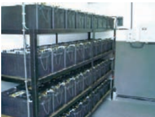
Banco de baterias antigo
