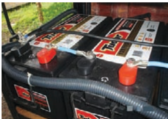
Figura 10.7 – Terminais da bateria e conexão dos cabos
