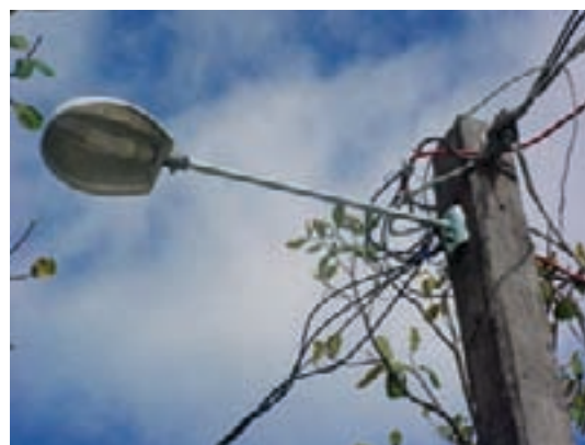
Luminária do sistema de iluminação pública
