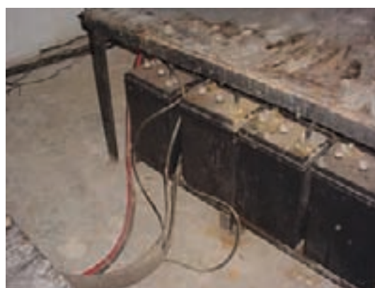
Banco de baterias antigo
