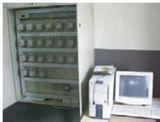
Sistema de monitoração remota
