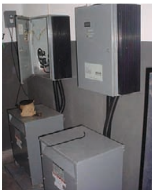
Retificadores fixados na parede e transformadores (abaixo)
