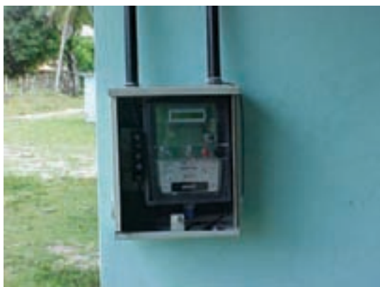
Medidor de energia (sistema pré-pago)
