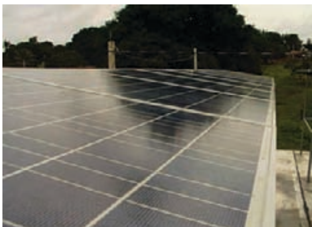
(a) Arranjo fotovoltaico
