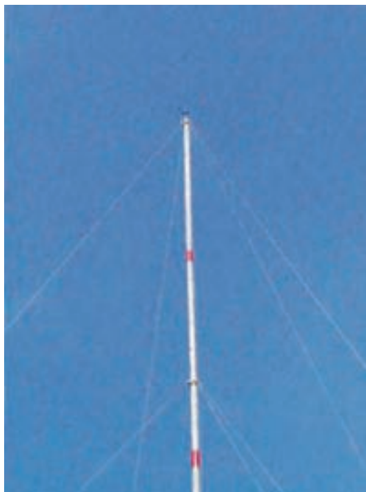
Torre estaiada da estação meteorológica
