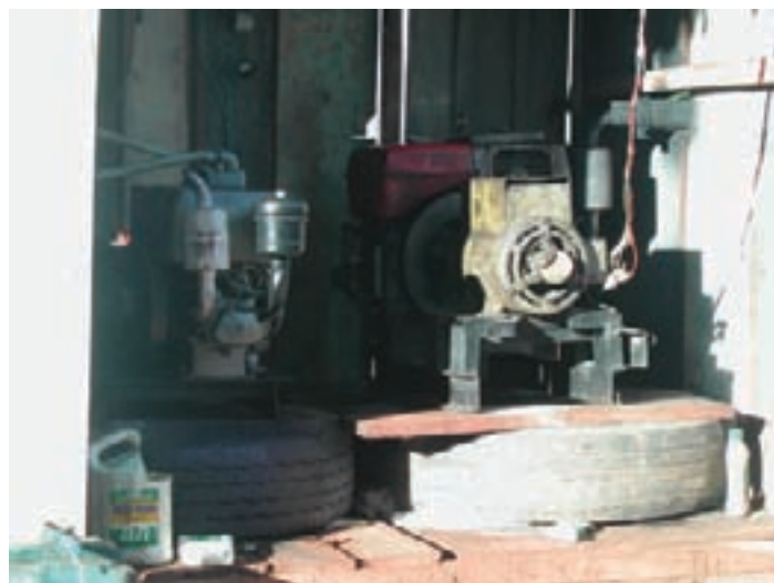
Figura 9.4 – Gerador diesel usado na comunidade de Canaã
