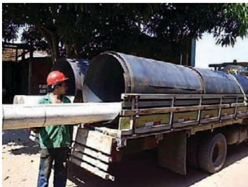
Figura 9.49 – Conduto forçado para a \mu CH Aruã
