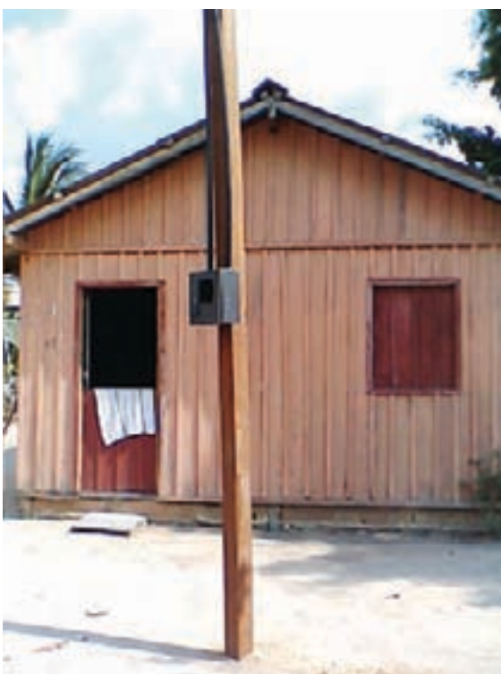
Figura 9.34 – “Padrão” instalado a espera da ligação
