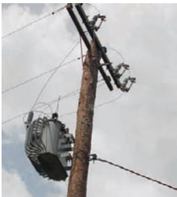
Figura 9.39 – Transformador elevador de tensão
