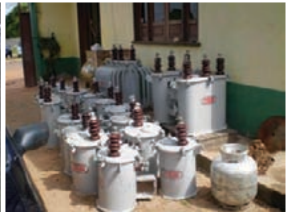
Figura 9.26 – Transformador elevador e transformadores abaixadores
