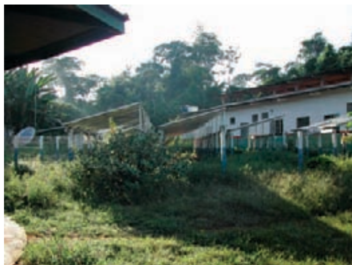
Figura 9.5 – Painéis fotovoltaicos da escola da comunidade de Canaã
