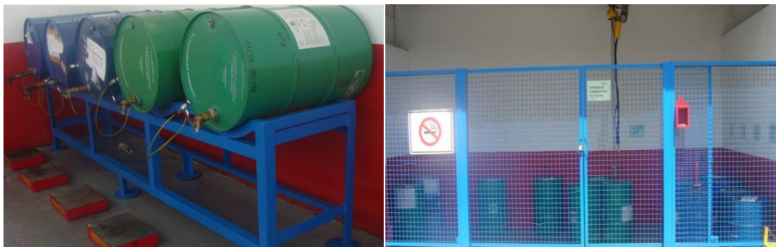
Figura 5: Infraestrutura de abastecimento da mistura B10.
