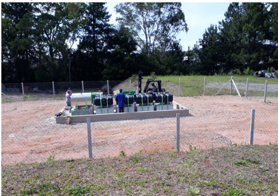
Figura 02 – Vista frontal da estrutura de armazenamento de combustível
