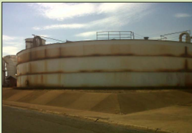
Biodigestor instalado na Usina São Martinho.
