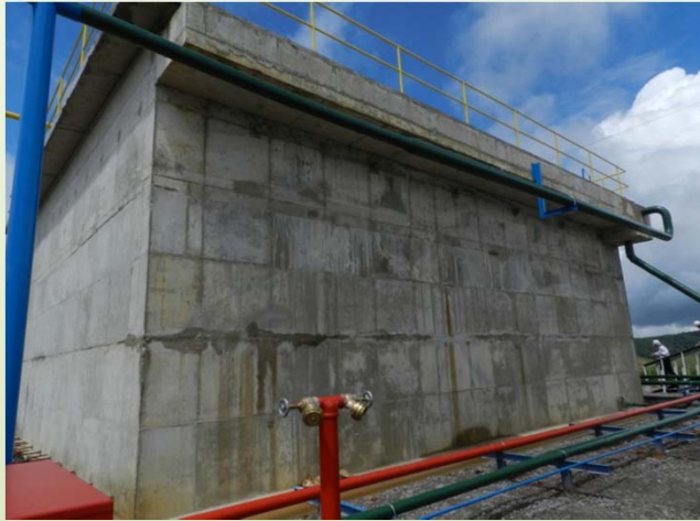
Biodigestor em Vitória de Santo Antão, PE.
