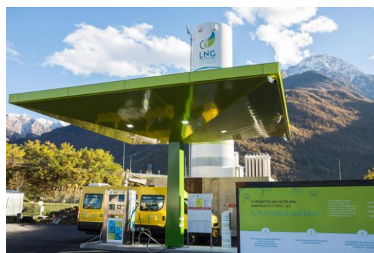
LNG filling station Gera Lario
