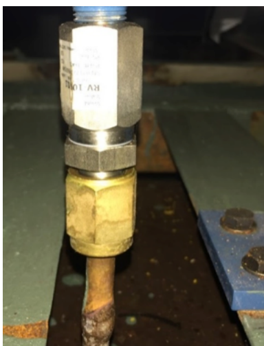
Figura 39 – Saída de óleo do separador de óleo com adaptador para brasagem e flange industrial
