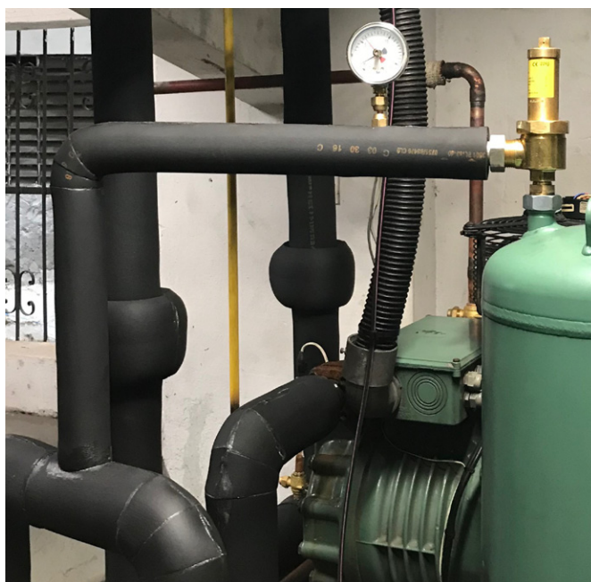
Figura 38 – Detalhe da válvula de segurança do recipiente de líquido
