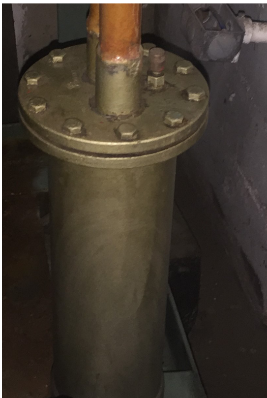
Figura 19 – Separador de óleo com vedação deficiente
