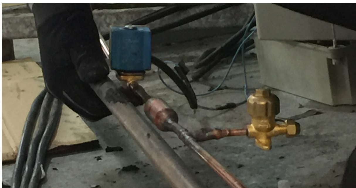
Figura 29 – Filtro na linha de líquido
