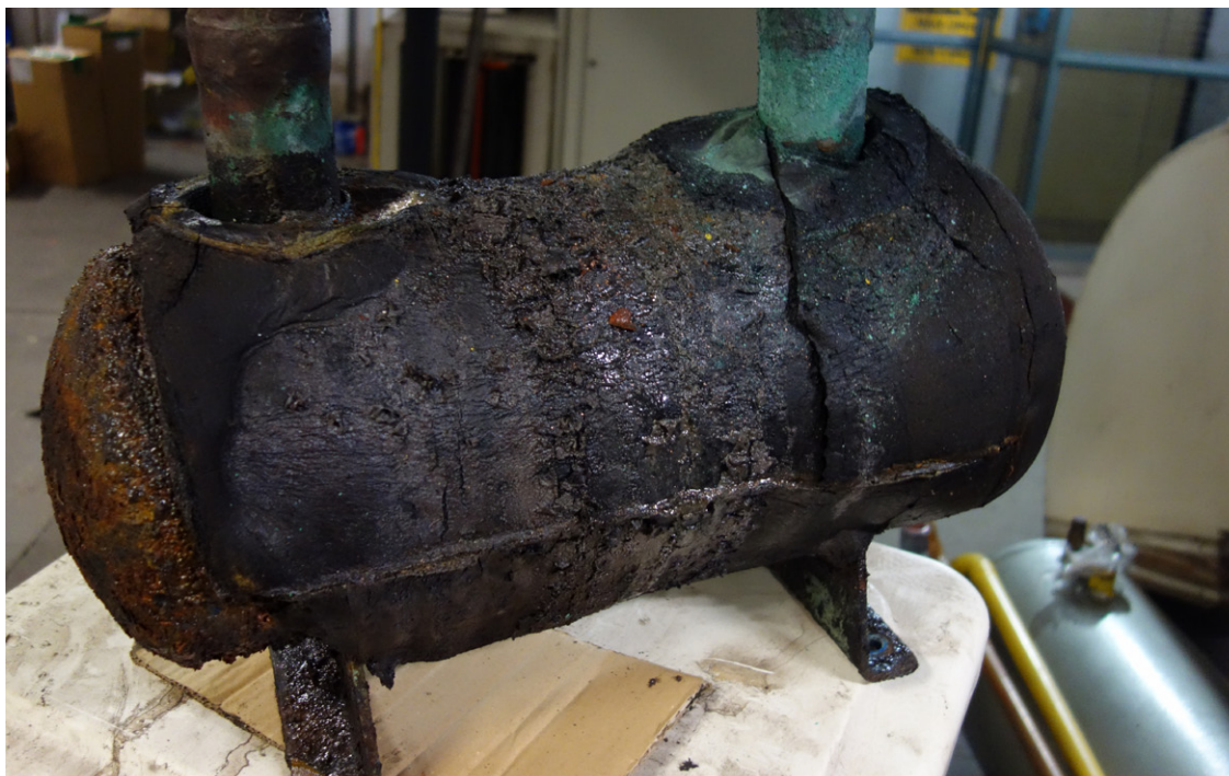
Figura 21 – Acumulador de sucção completamente corroído
