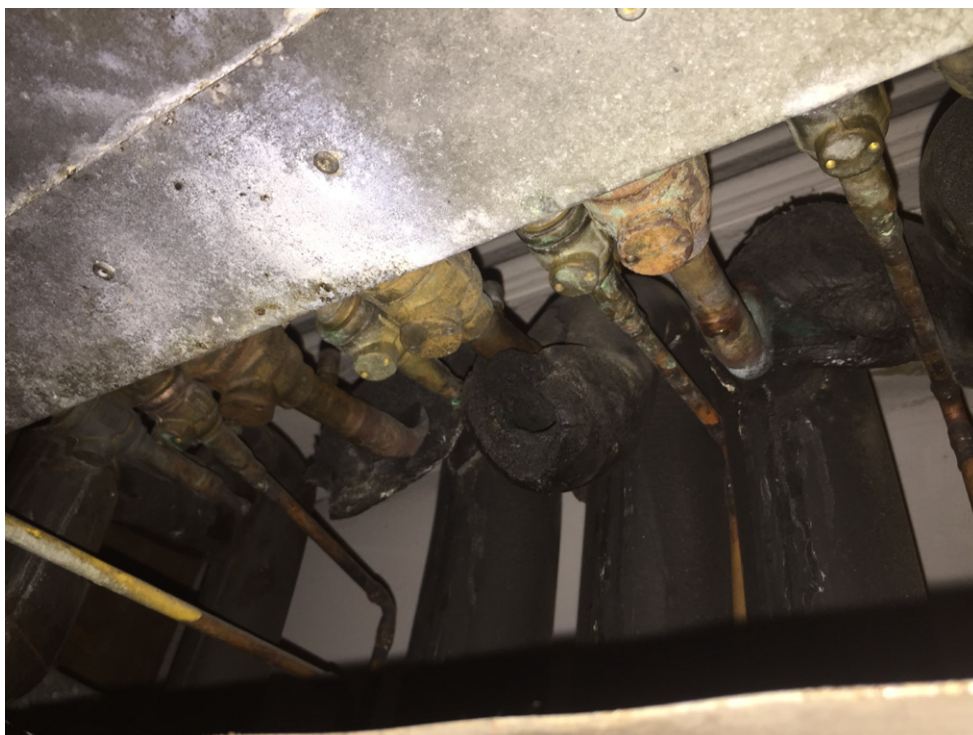
Figura 18 – Válvulas esferas que apresentaram vazamento
