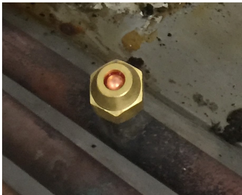
Figura 31 – Válvula Schrader para tomada de pressão no tubo de sucção do expositor de laticínios/iogurtes
