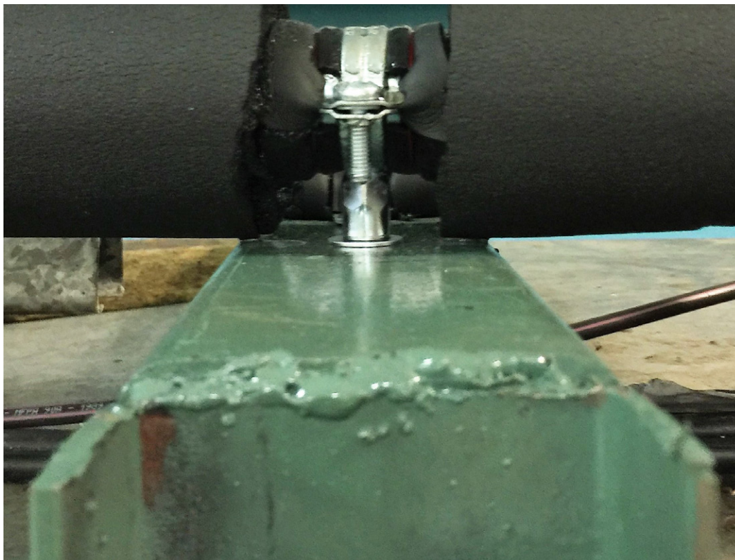
Figura 46 – Tubo de cobre (sucção) com fixador e apoiado em suporte (vista frontal)
