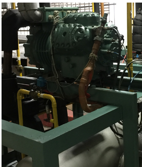
Figura 34 – Rack de resfriados antes da intervenção
