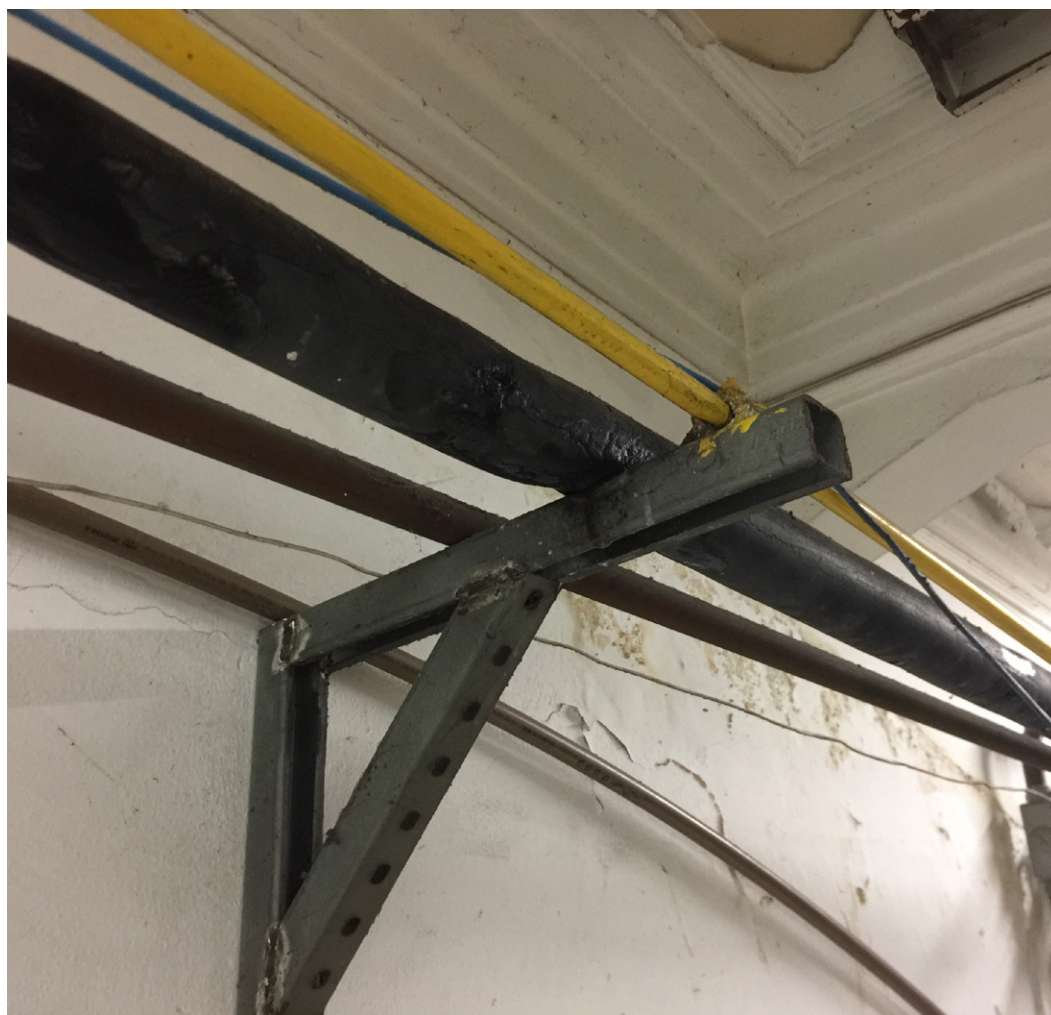
Figura 17 – Tubulação solta nos suportes e com isolamento deficiente
