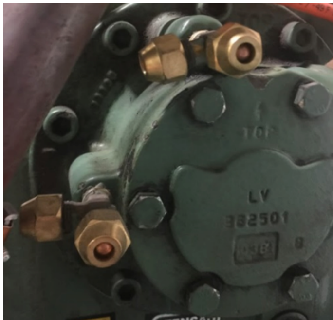
Figura 42 – Tomadas de pressão no compressor vedadas com porca sextavada e selo de cobre
