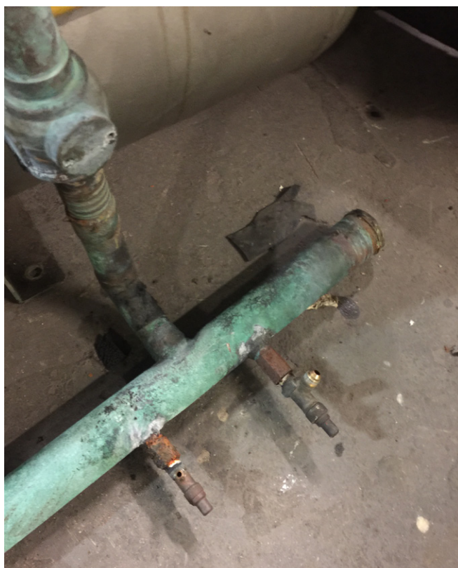
Figura 20 – Coletor de sucção com conexões corroídas
