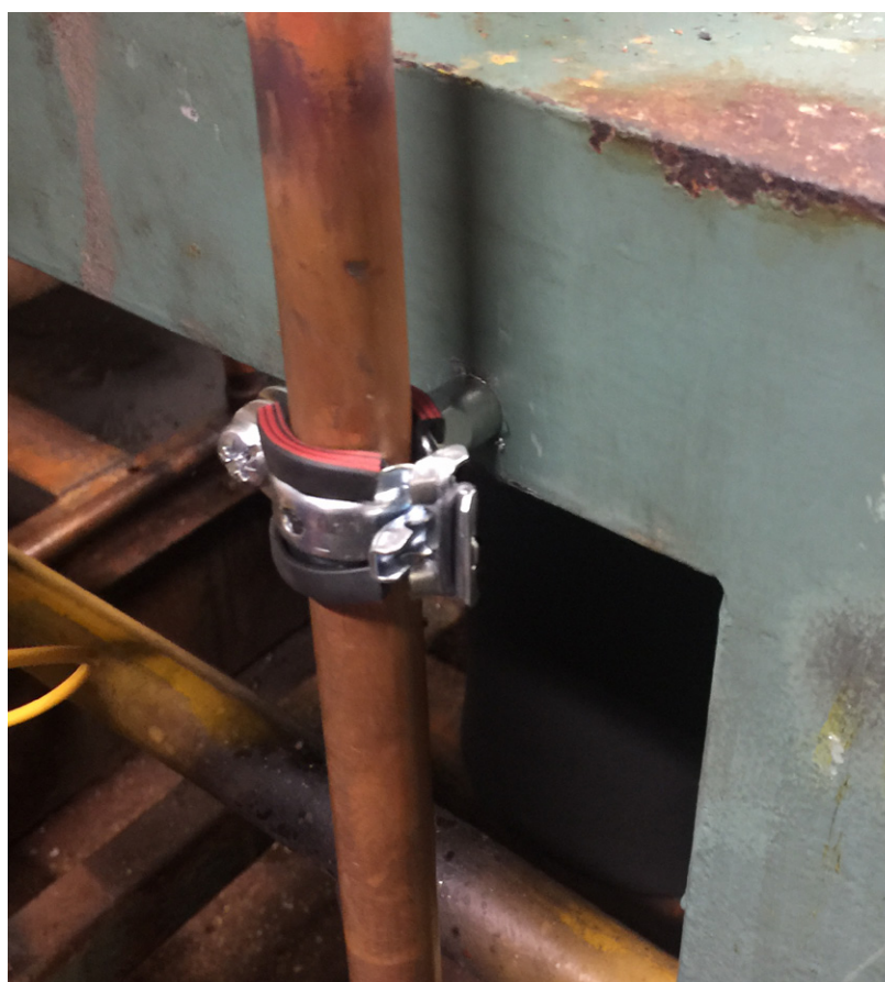
Figura 49 – Tubo de cobre (líquido) fixado na estrutura do rack
