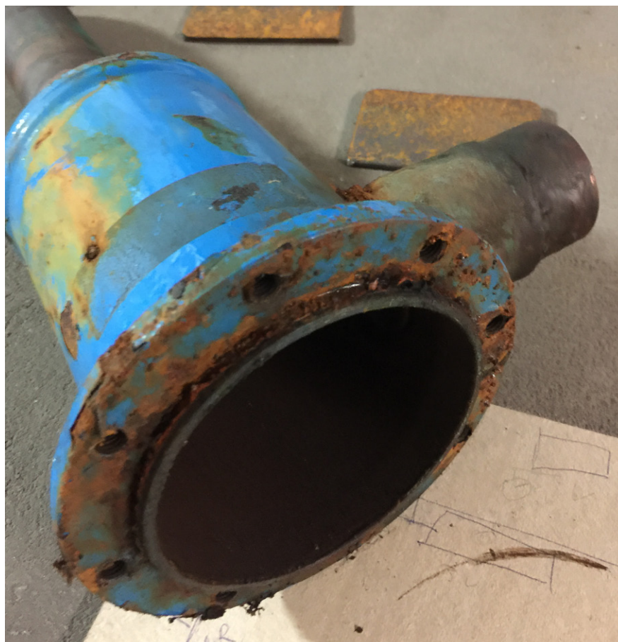
Figura 22 – Filtro de sucção corroído
