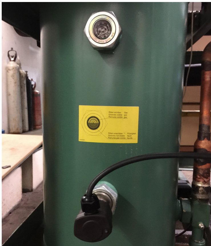
Figura 61 – Sensor de nível de fluido refrigerante no recipiente de líquido sem alarme (luz apagada)
