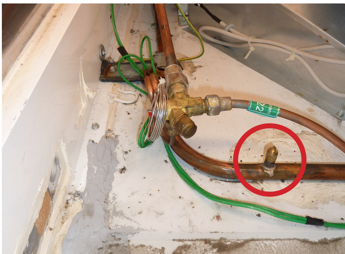
Figura 16 – Válvula Schrader instalada diretamente na tubulação sem tamponamento adequado
