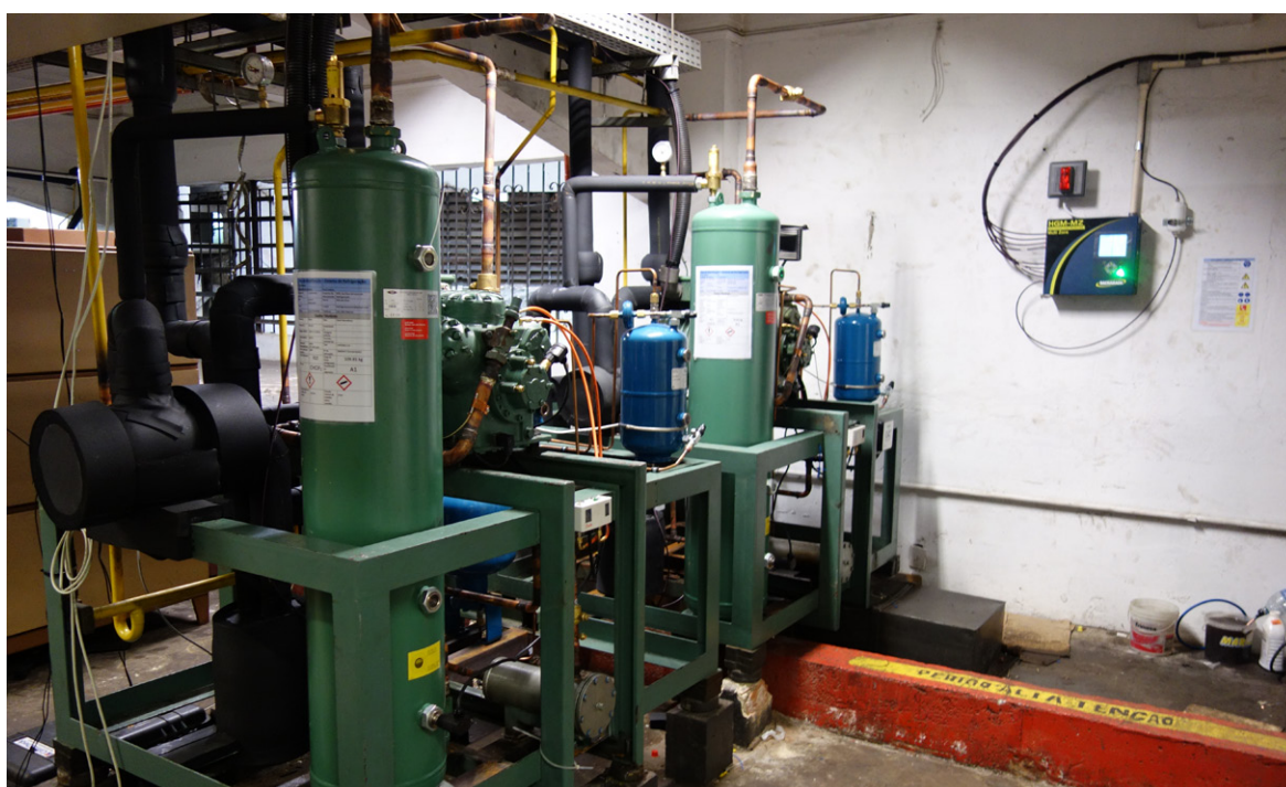
Figura 54 – Casa de máquinas após a intervenção e fichas técnicas fixadas nos racks
