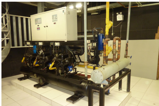
Figura 13 – Rack de compressores para o regime de resfriados utilizando HCFC-22
