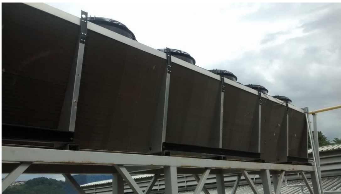
Figura 42 – Condensador com seis ventiladores para o ciclo D (HFC-134a)
