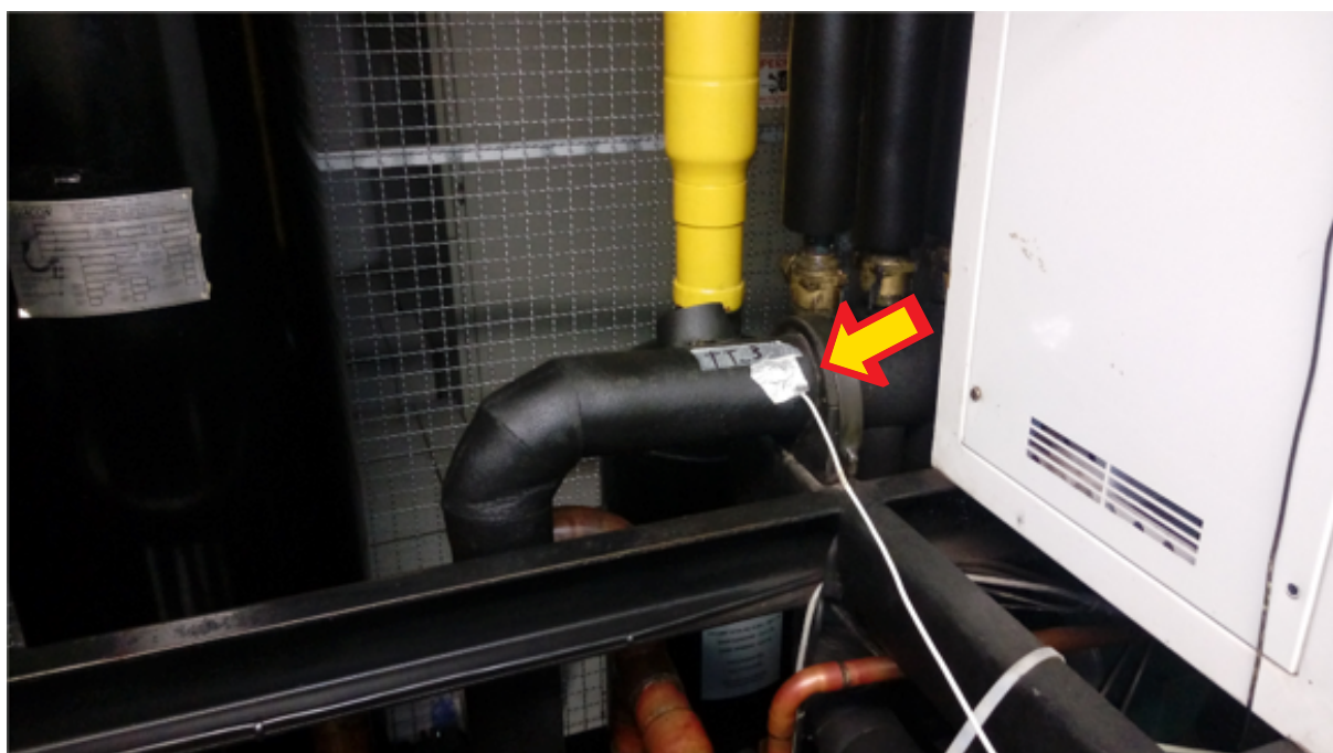
Figura 46 – Sensor de temperatura do equipamento Climacheck na linha de líquido
