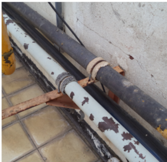
Figura 36 – Fixação inadequada da tubulação
