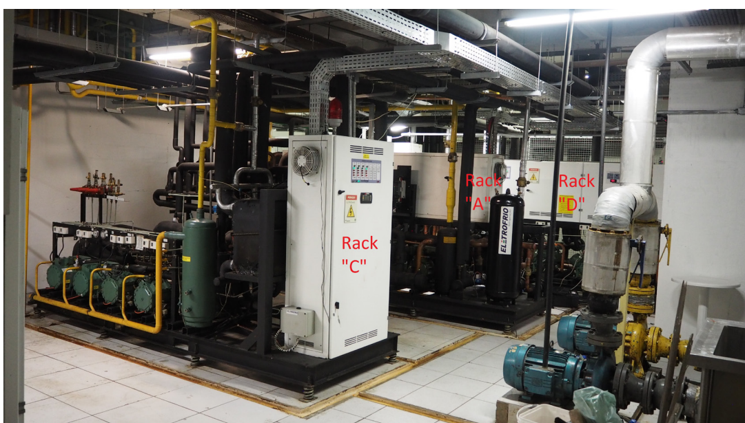
Figura 43 – Sala de máquinas com os rack de compressores A, C e D
