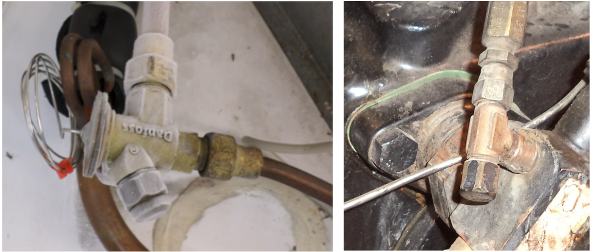
Figura 27 – Quantidade elevada de conexões por flange (algumas com vazamento evidente)
