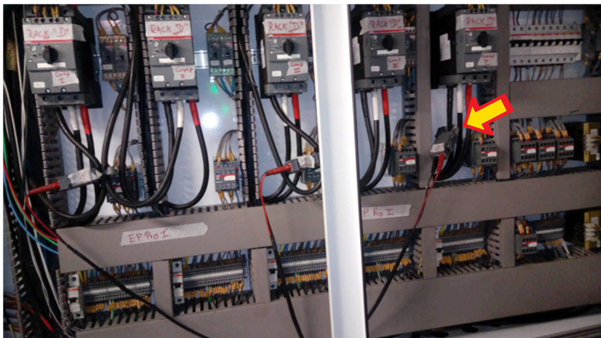
Figura 45 – Braçadeiras para medição da corrente dos compressores do ciclo D (MT, HFC-134a)
