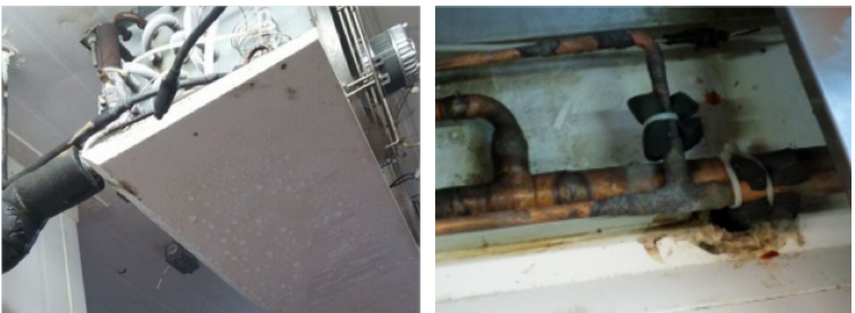
Figura 29 – Exemplos de conexões brasadas com vazamento
