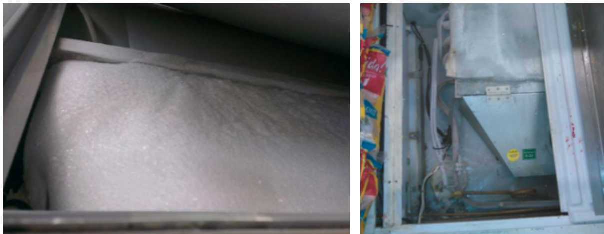
Figura 33 – Formação de camada de gelo nos evaporadores (HCFC-22)
