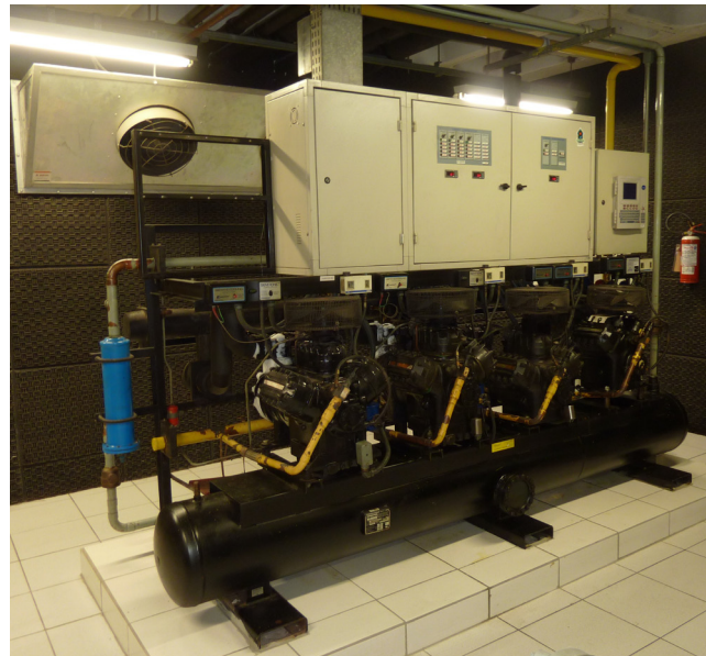
Figura 15 – Rack de compressores para o regime de congelados utilizando HCFC-22
