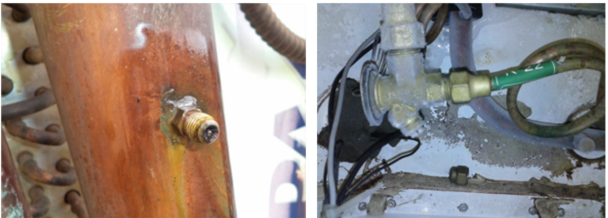
Figura 28 – Válvula Schrader sem vedação com vazamento
