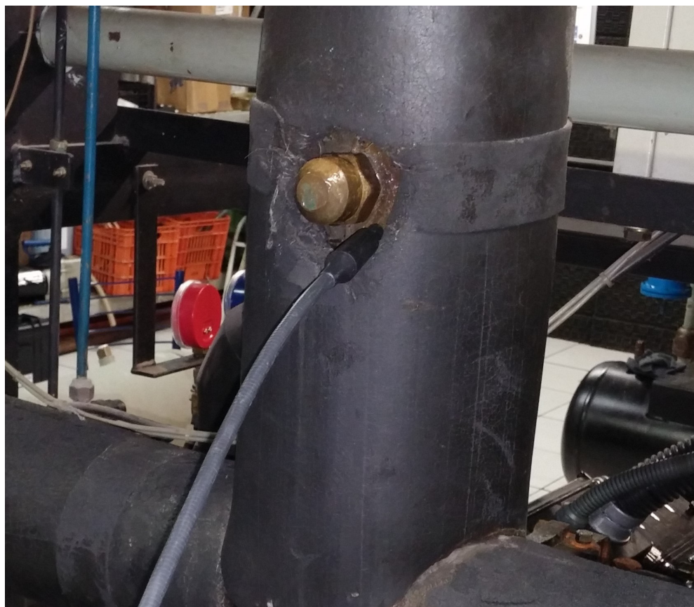
Figura 26 – Tampas sem orings adequados utilizados nas válvulas de passagem
