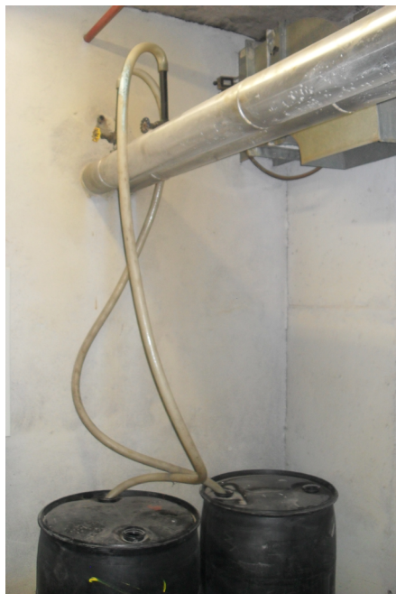
Figura 38 – Sistema de Purga de Ar Manual Improvisada.
