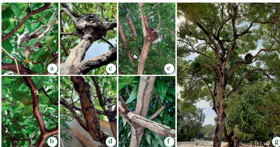
Figura 6.7 – Ocorrência de cupins: a e b) castanhola; c e d) cajueiro; e e f) mangueira e g) ipê-amarelo.
