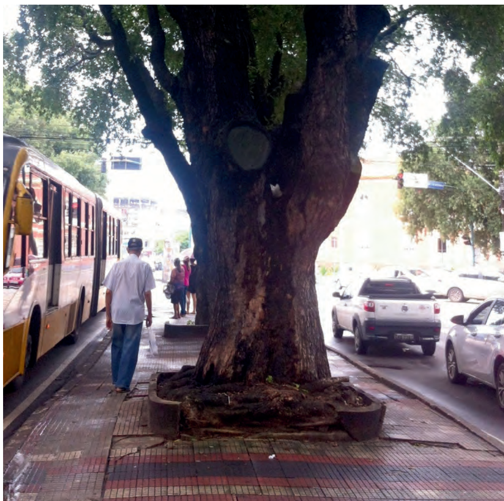
Figura 4.2 – Conflito físico entre o calçamento do canteiro central e o sistema radicular ( Moquilea tomentosa – oiti), Manaus (AM).
