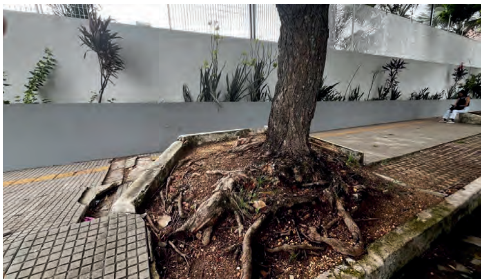
Figura 9.2 – Raízes ocasionando danos à calçada.
