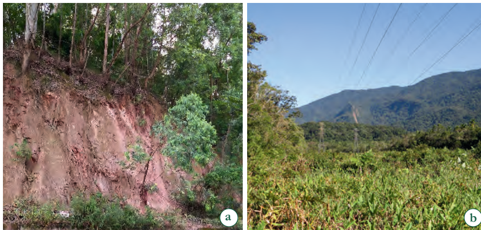
Figura 6.5 – Nível 1 de inspeção de árvores de risco a) Talude em processo erosivo e raízes de árvores de eucalipto expostas; b) Rede de distribuição: supressão de todas as árvores.
