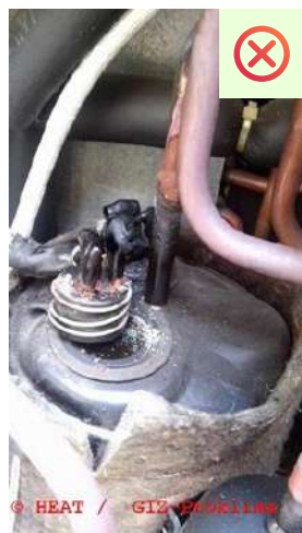
Figura 457 – Exemplo de terminais de cabos inadequados (soltos), que causam arcos elétricos e queimam o fio
