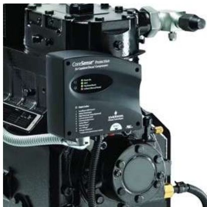
Figura 264 – Exemplo de pressostato de diferencial do óleo instalado por profissional
