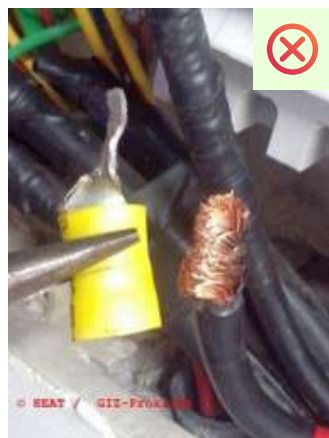
Figura 455 – Exemplo de terminal de cabo instalado incorretamente
