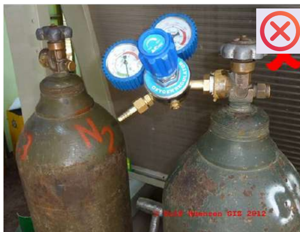
Figura 166 – Exemplos de marcação inadequada e perigosa de cilindro (N 2 esquerda / O 2 direita)
