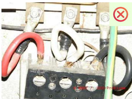
Figura 456 – Exemplo de falta de luvas no condutor de energia
