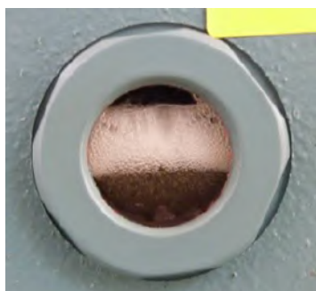
Figura 272 – Compressor em condição
