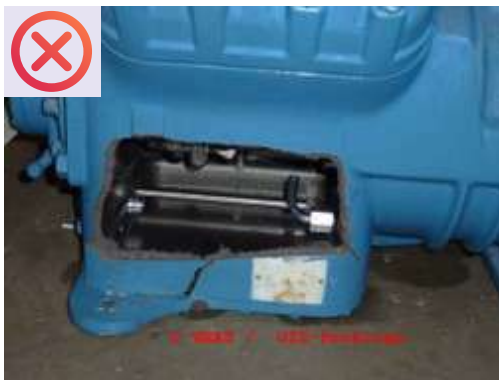
Figura 169 – Carcaça de compressor destruída, uso falso de nitrogênio seco sem oxigênio para testes de pressão sem regulador de pressão
