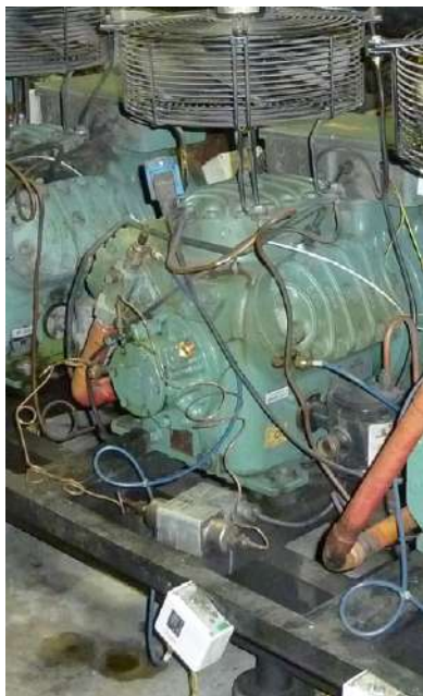
Figura 266 – Exemplo de pior instalação e manutenção do pressostato do diferencial do óleo
