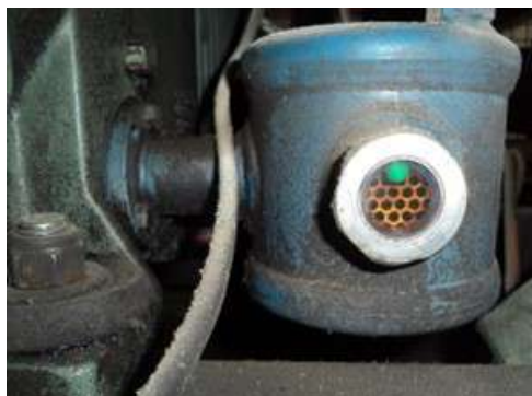
Figura 274 – Compressor e regulador do nível de óleo com manutenção ruim
