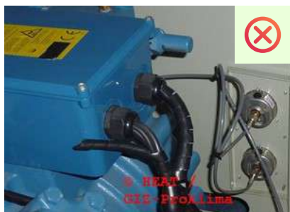
Figura 435 – Inserção inadequada de mais de um cabo em um terminal de um compressor
