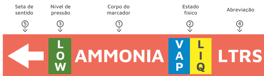
Figura 375 – Identificação da tubulação de amônia
