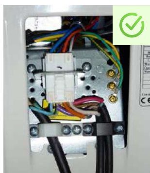
Figura 452 – Exemplo de conexão elétrica de um ar condicionado do tipo split (unidade externa)
