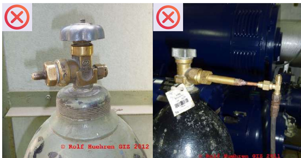
Figura 168 – Conexão de mangueira de transferência proibida com adaptador criado pelo usuário para um cilindro de gás comprimido (aqui, N_2 ) mostrada na imagem à direita; conexão proibida sem regulador de pressão ( N_2 ) mostrada na imagem à esquerda
