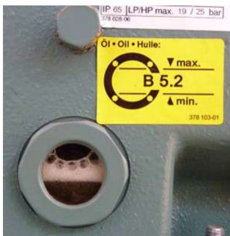
Figura 267 – Visor de líquido do compressor Bitzer e verificação do nível de óleo
