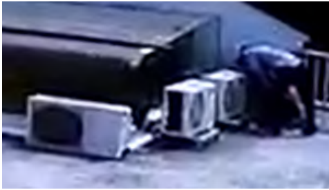
Figura 86 – Suspeita de operação de recolhimento de fluido refrigerante para dentro do condensador (“pump out”)
