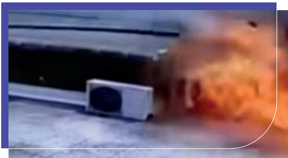
Figura 161 — Explosão e combustão rápidas e grandes
