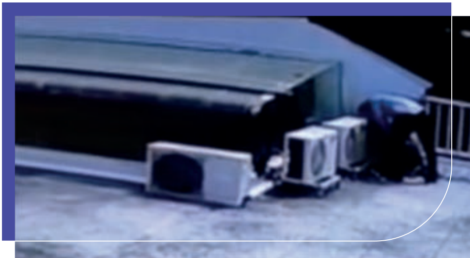
Figura 160 — Suspeita de operação de recolhimento para unidade externa (“ pump-out ”) em aparelho de ar condicionado do tipo split
