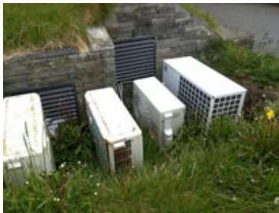
Figura 135 — Exemplo de instalação inadequada da unidade externa
