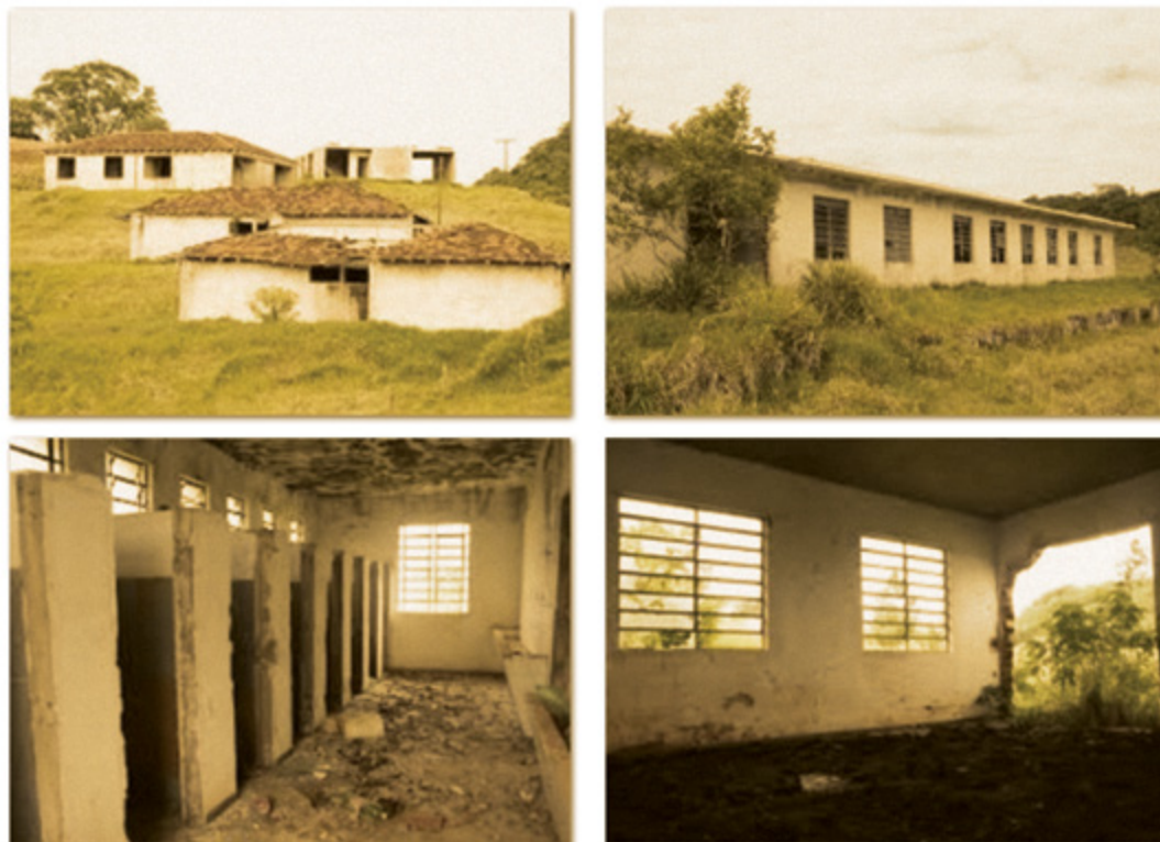
Fig. 29. Aspectos atuais dos edifícios da Colônia Penal Agrícola de Tamarana, que serviu de depósito temporário para agrotóxicos organoclorados e é um dos passivos ambientais sob tutela do Estado do Paraná.
